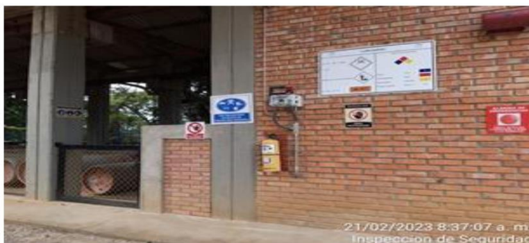
Anexo 2. Sala de Cloración
