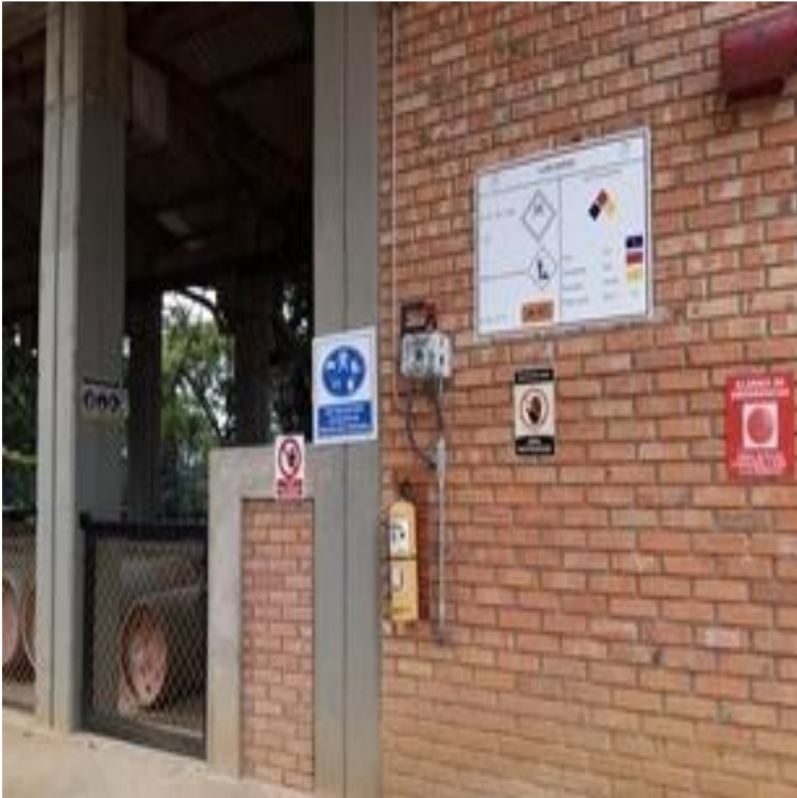
Anexo 2. Sala de Cloración
