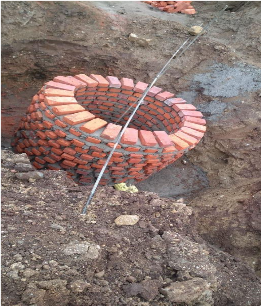
Figura 12.foto donde se observa la forma que va dando el pozo de inspección
