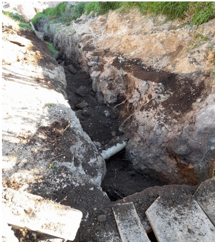
Figura 25. Foto donde se observa la instalación de las tiras de tubería de alta presión.
