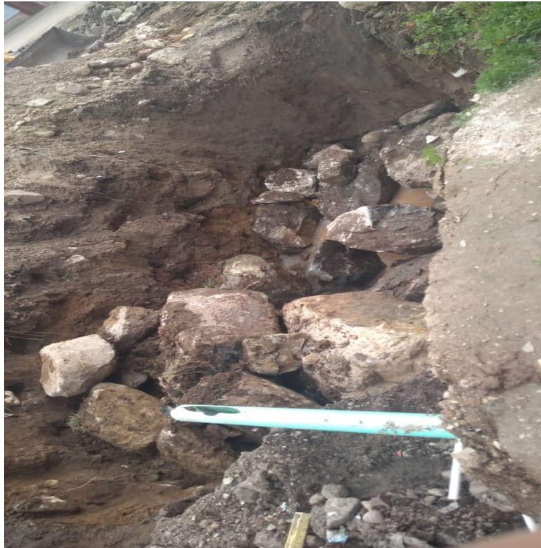
Figura 27. Foto donde se observa rompimiento de tubería
