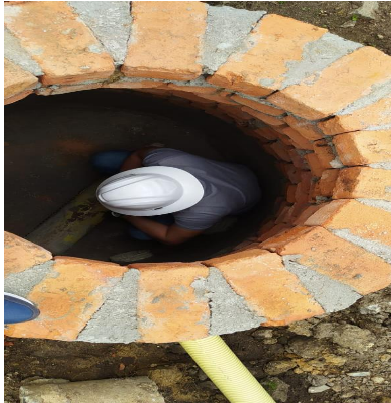
Figura 15. Foto donde se observa en pozo y se verifica la ubicación de tubería
