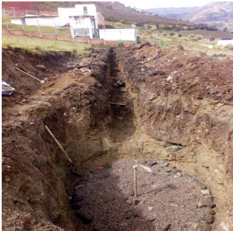
Figura 6. Foto donde se observa instalación triturado de \frac{1}{2} " y \frac{3}{4} " aislante Para zapatas pozos de inspección
