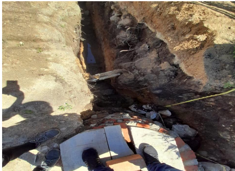
Figura 26. Foto donde se observa fuga de agua
