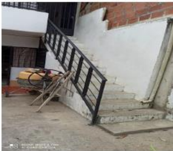
Ilustración 1. En el lugar se observa, una escalera construida sobre la vía o espacio público.
