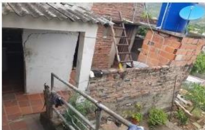
Ilustración 3. Se evidencia agrietamiento de paredes
