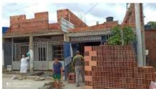
Ilustración 2. Se evidencia bloques sobre la vía pública.
