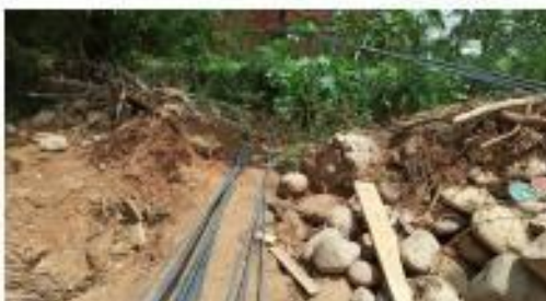
Ilustración 3. Se observan escombros y acero en la obra.
