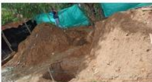
Ilustración 2. Se observa personal de trabajo sin tener los elementos de protección para dicha actividad.
