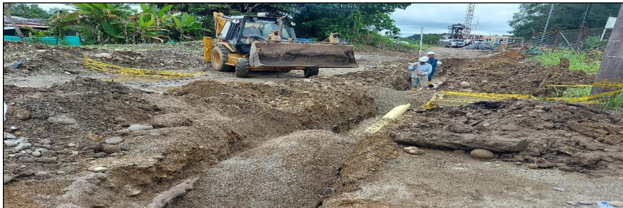
Imagen 15. Instalación de tubería para la conexión de las cámaras con los sumideros.
