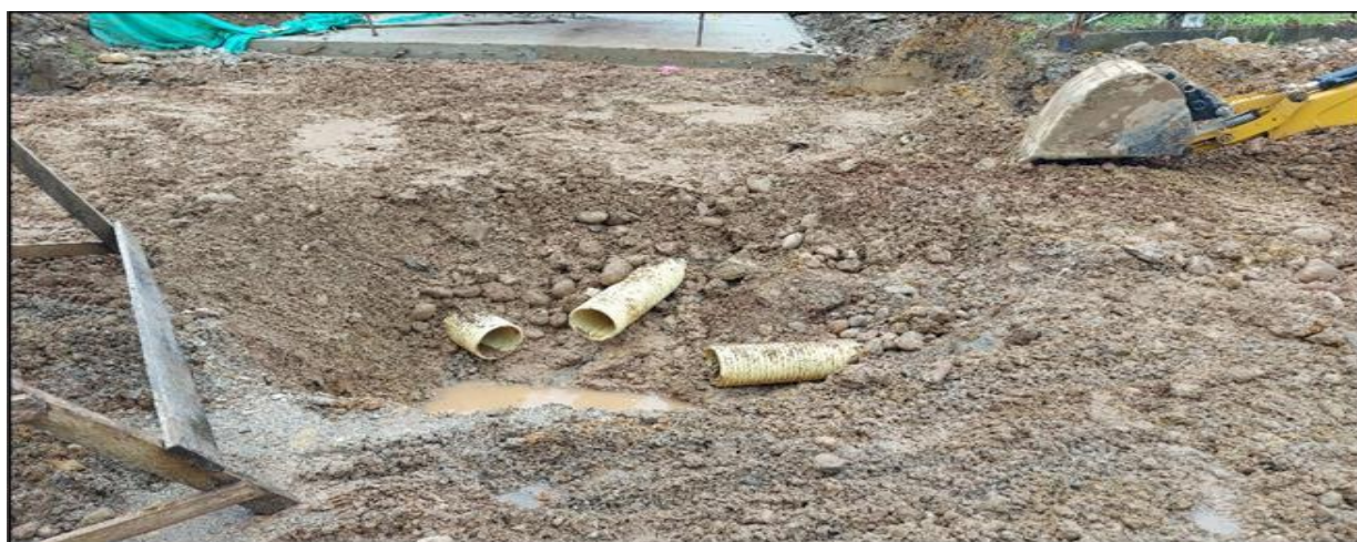
Imagen 12. Tubería sanitaria del sistema de alcantarillado.
