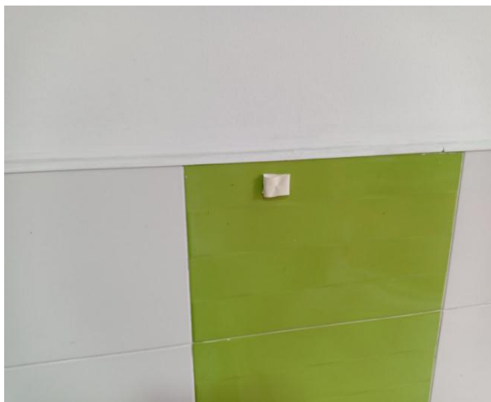
Figura 43. Evidencia fotográfica hallazgos realizados en rondas de seguridad, unidad sin identificación
