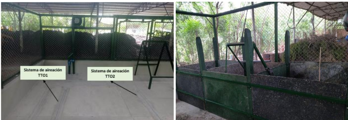
Figura 28. Diseño y distribución de la aireación para los dos sistemas de aireación forzada y los módulos del sistema autónomo
