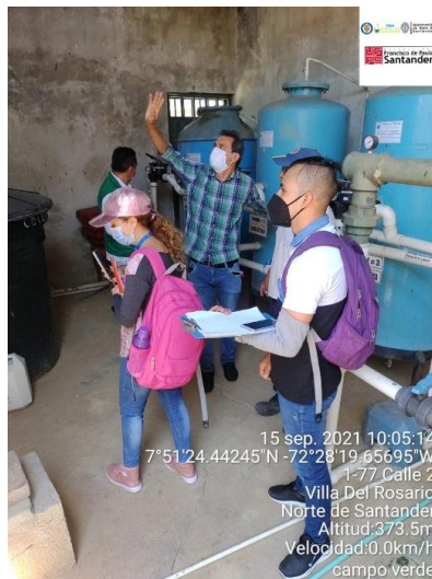
Figura 69. Baterías filtrantes. ASOCAMVE
