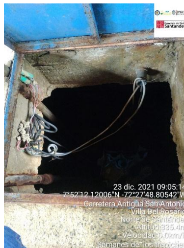
Figura 129. Tanque de almacenamiento PTAP Samanes de los Trapiches
