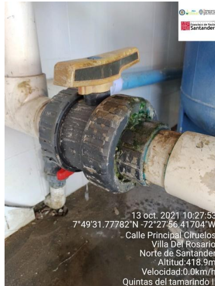
Figura 107. Válvulas en mal estado, con fuentes altas de contaminación planta Quintas del Tamarindo II
