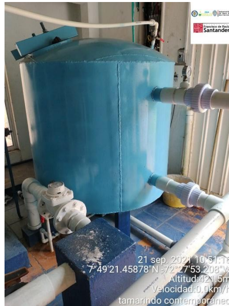
Figura 89. Batería filtrante# 2. Carbón activado. PTAP Tamarindo Contemporáneo
