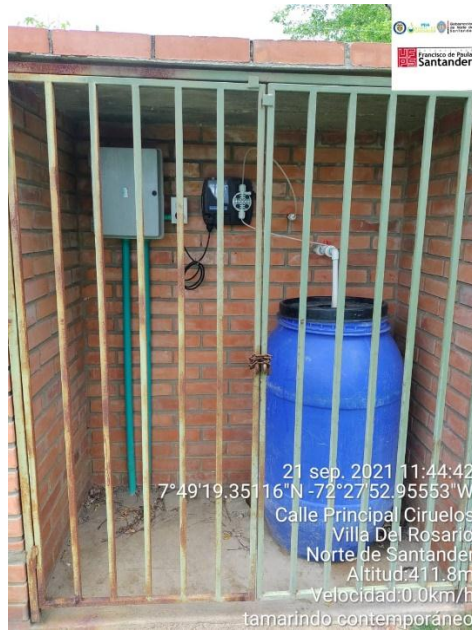
Figura 87. Bomba dosificadora de cloro, salida del pozo de abastecimiento. PTAP
