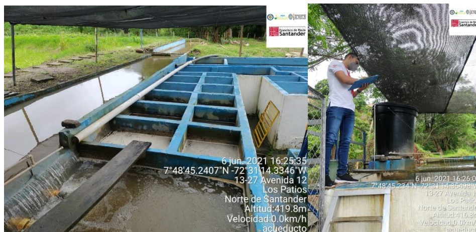
Figura 15. Estructura del Desarenador #2, mezcla Rápida y Floculador. PTAP Tierra Linda
