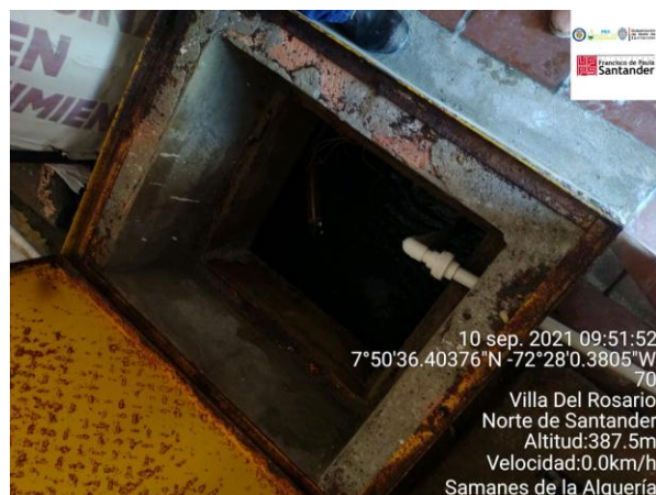
Figura 52. Tanque de almacenamiento PTAP Samanes de la Alquería
