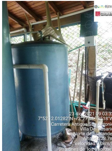
Figura 125. Batería filtrante arenas finas PTAP Samanes de los Trapiches
