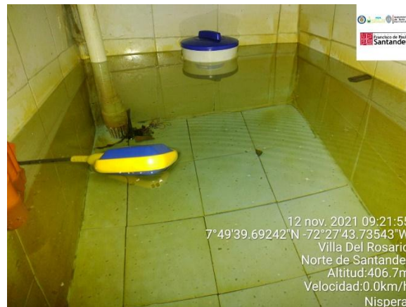
Figura 112. Tanque de cloración. El Nisperal
