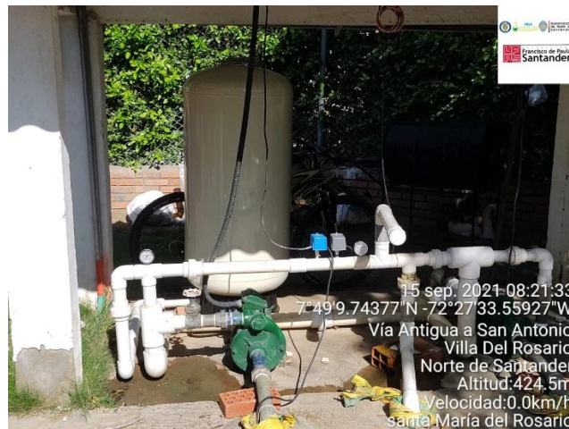
Figura 63. Zona de bombeo PTAP Santa María del Rosario
