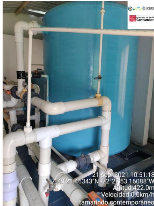
Figura 90. Batería filtrante #3. Resina catiónica. PTAP Tamarindo Contemporáneo
