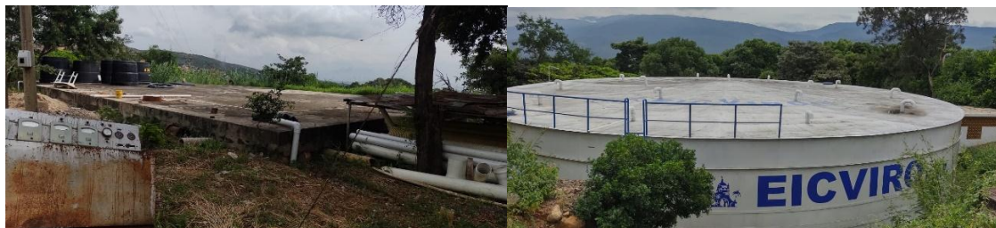
Figura 38. Tanques de almacenamiento. AQUALIA
