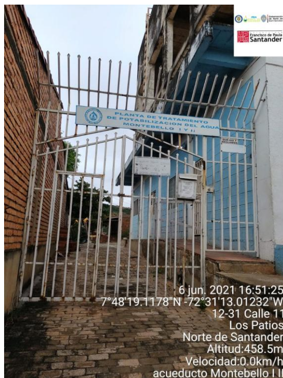
Figura 25. Ingreso planta de tratamiento Montebello
