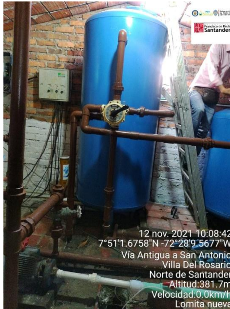
Figura 118. Batería tipo suavizados de resina catiónica PTAP Lomita Nueva
