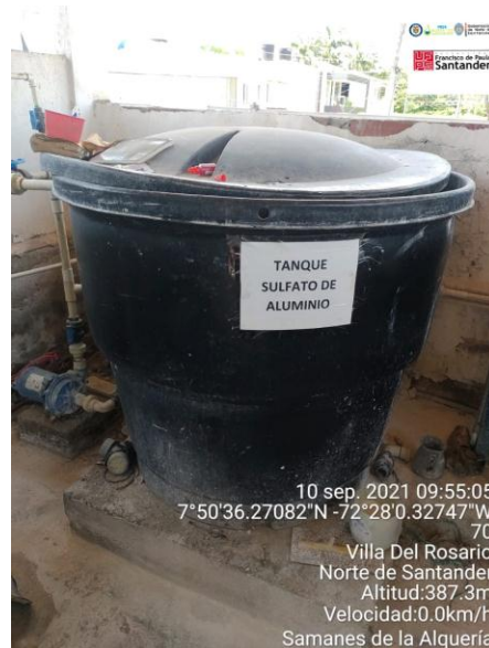
Figura 47. Tanque de preparación y dosificación de sulfato de aluminio. PTAP Samanes de los Trapiches
