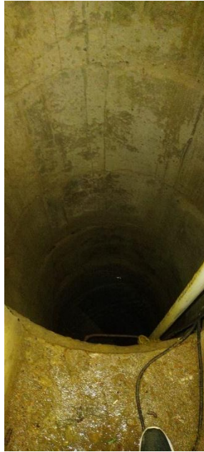
Figura 111. Pozo de agua subterránea. El Nisperal
