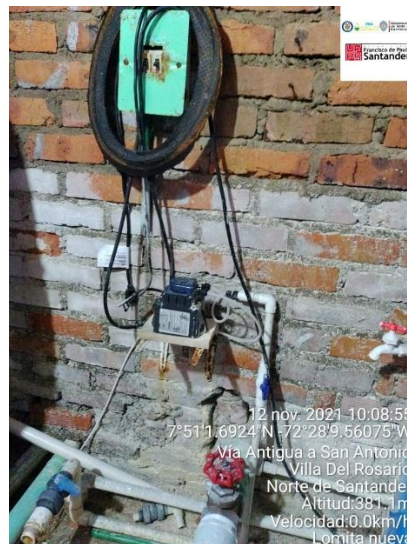
Figura 119. Bomba de cloración averiada. PTAP Lomita Nueva
