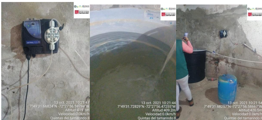
Figura 105. Bomba dosificadora y zona de cloración planta Quintas del Tamarindo II
