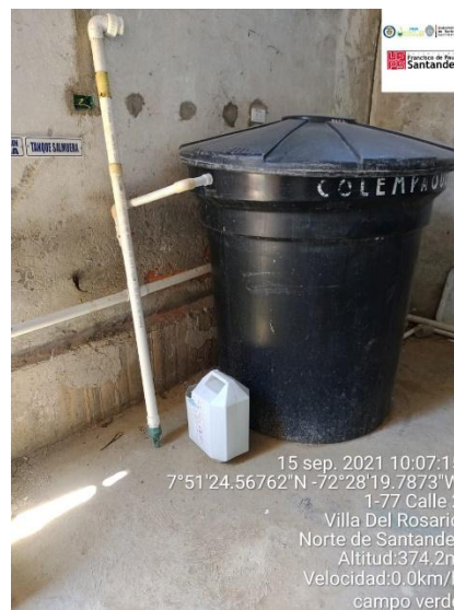
Figura 72. Tanque preparación de salmuera. ASOCAMVE
