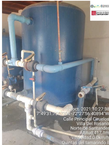
Figura 104. Batería de resina catiónica fuera de servicio planta Quintas del Tamarindo II
