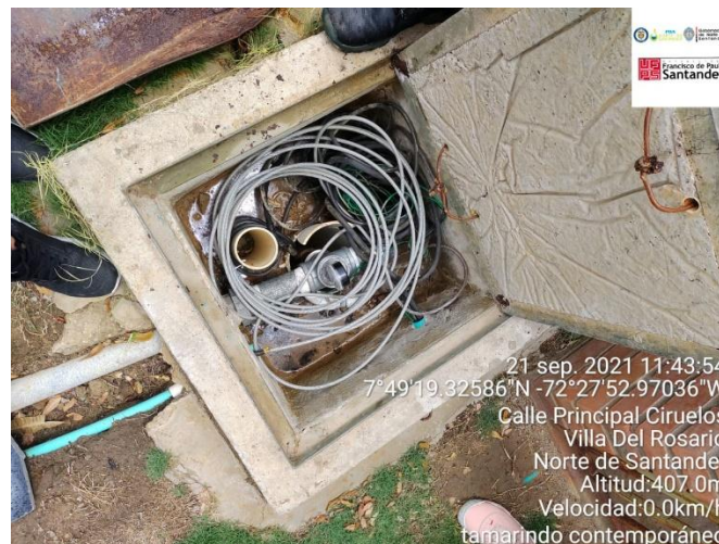
Figura 86. Pozo subterráneo, perforado tipo puntilla, fuente de abastecimiento. PTAP Tamarindo Contemporáneo
