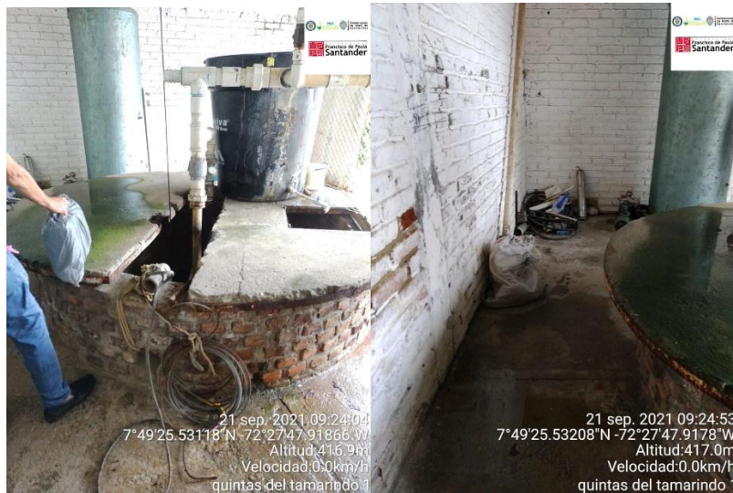
Figura 78. Posibles fuentes de contaminación en fuente de abastecimiento. PTAP Quintas del Tamarindo I
