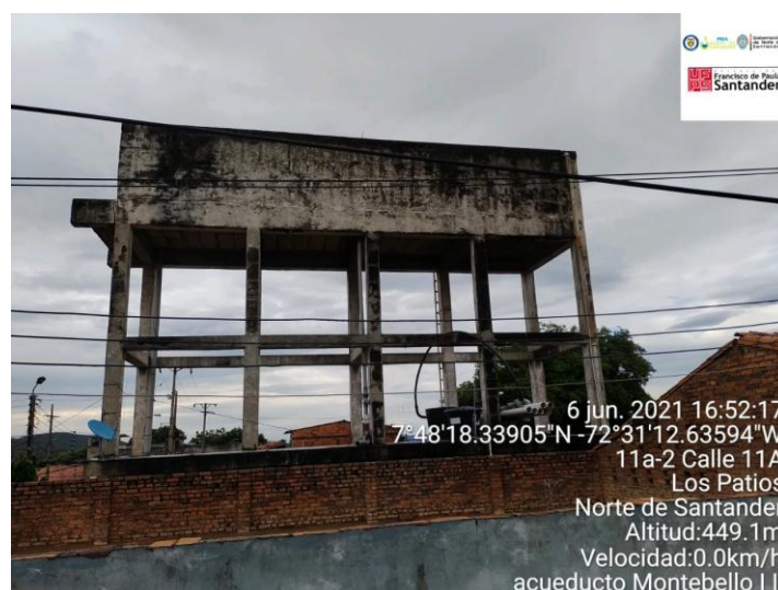
Figura 31. Estructura del tanque de almacenamiento. APYUM
