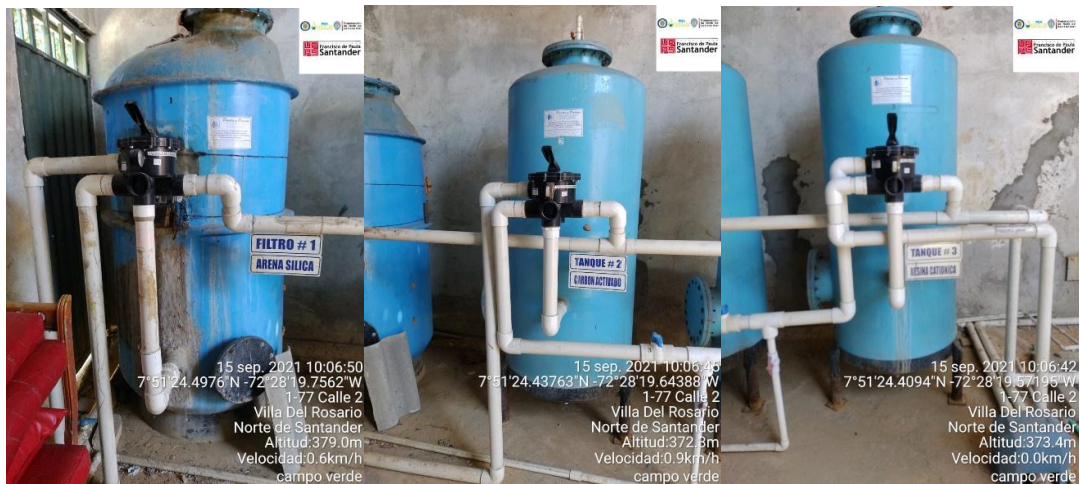
Figura 70. Filtro de arena silica, carbón activado y resina catiónica. ASOCAMVE
