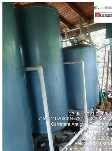
Figura 126. Batería filtrante de carbón activado PTAP Samanes de los Trapiches
