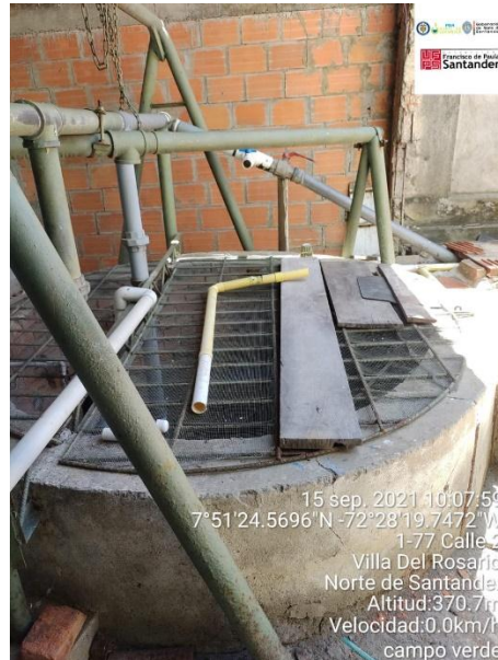
Figura 67. Pozo subterráneo, fuente de abastecimiento. ASOCAMVE
