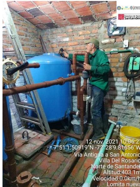
Figura 117. Batería filtrante de arenas y carbón activado PTAP Lomita Nueva
