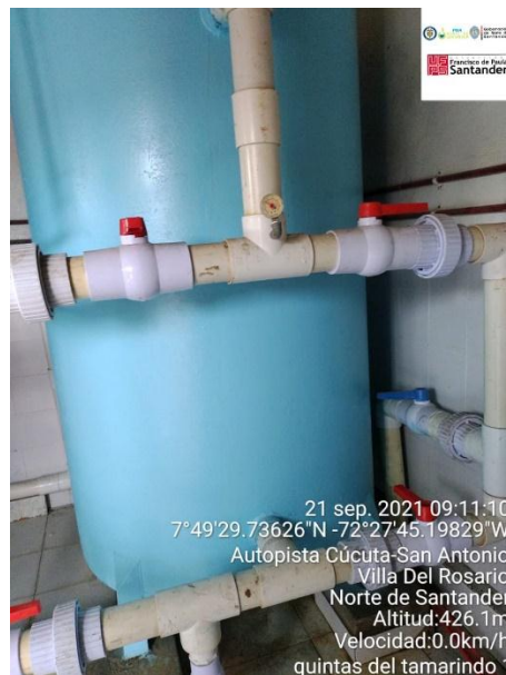
Figura 80. Batería filtrante de resina catiónica tipo suavizador. PTAP Quintas del Tamarindo I
