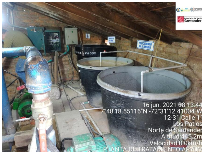
Figura 29. Equipo y tanque de cloración. APYUM
