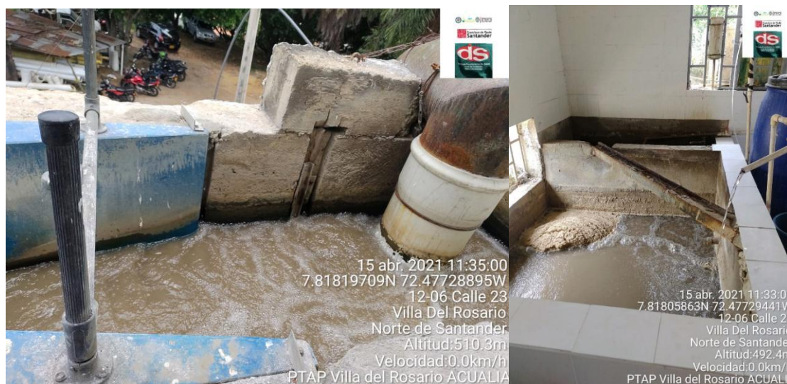
Figura 34. Estructura de la canaleta de parshall y zona de mezcla rápida. AQUALIA
