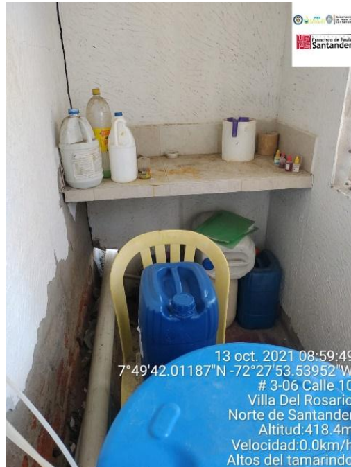
Figura 99. Lugar de cloración desordenado, sucio y con materiales no propios del lugar.
