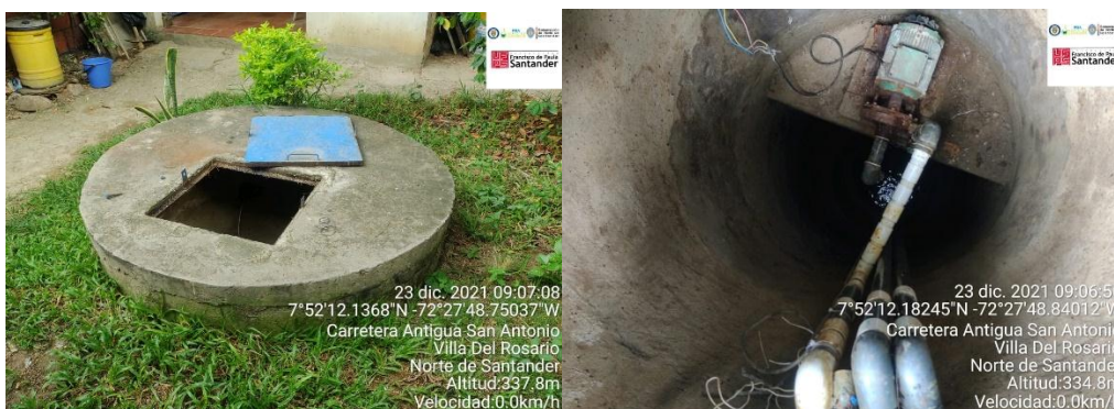
Figura 124. Pozo subterráneo PTAP Samanes de los Trapiches
