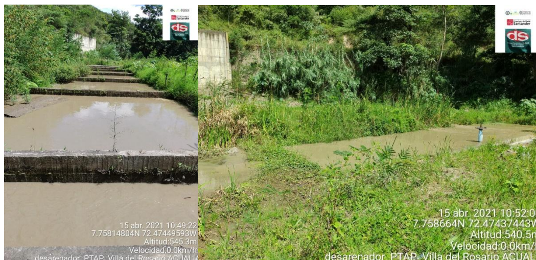
Figura 33. Estructura del desarenador N1 y N2. AQUALIA
