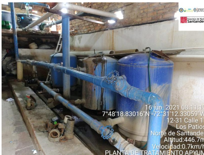
Figura 30. Filtros portátiles y sistema de válvulas. APYUM
