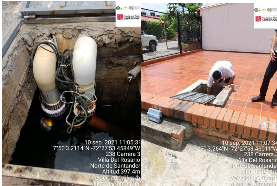
Figura 55. Tanque de almacenamiento. Villas de Santander
