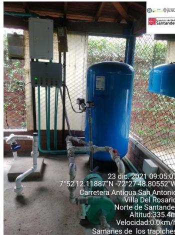
Figura 130. Zona de bombeo PTAP Samanes de los Trapiches
