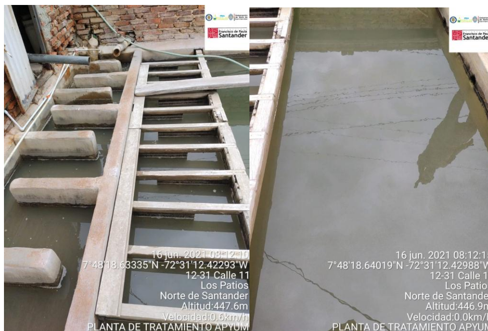
Figura 28. Estructura del floculador y sedimentador. APYUM
