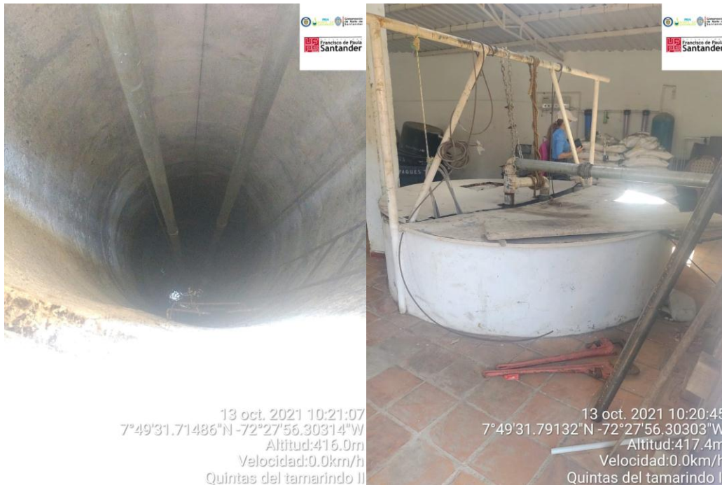
Figura 102. Pozo de agua subterránea. Fuente de abastecimiento PTAP planta Quintas del Tamarindo II
