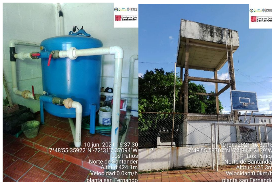
Figura 24. Filtro portátil adicional y tanque de almacenamiento. PTAP San Fernando
