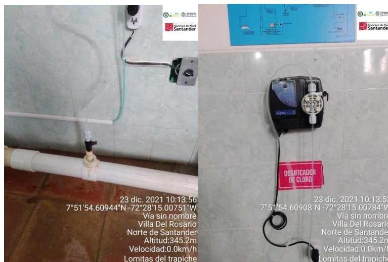
Figura 133. Zona de dosificación de cloro PTAP Lomita de los Trapiches
