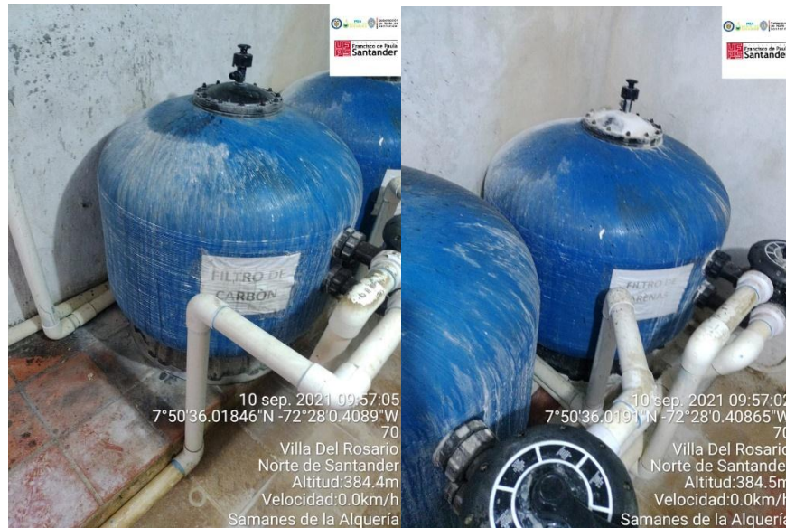
Figura 49. Baterías filtrantes, carbón activado y arenas. PTAP Samanes de los Trapiches
