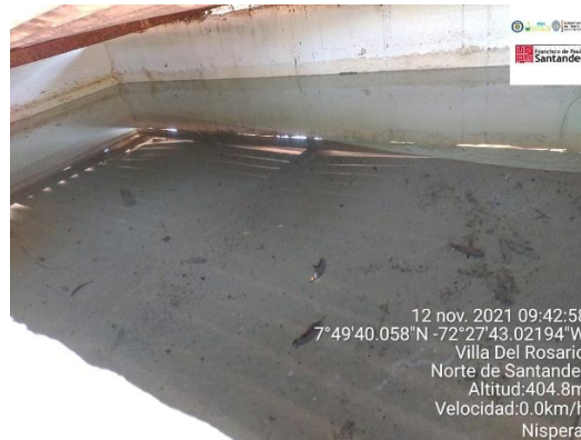
Figura 114. Tanque de almacenamiento casa 9 A. El Nisperal.
