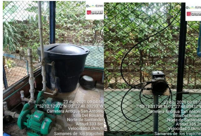
Figura 128. Tanque y bomba dosificadora de cloro PTAP Samanes de los Trapiches
