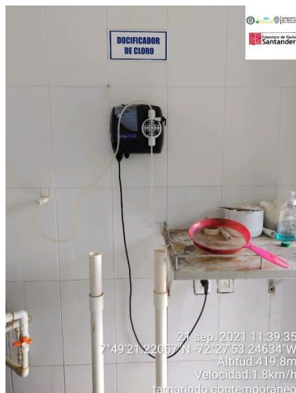
Figura 91. Bomba dosificadora de cloro. PTAP Tamarindo Contemporáneo
