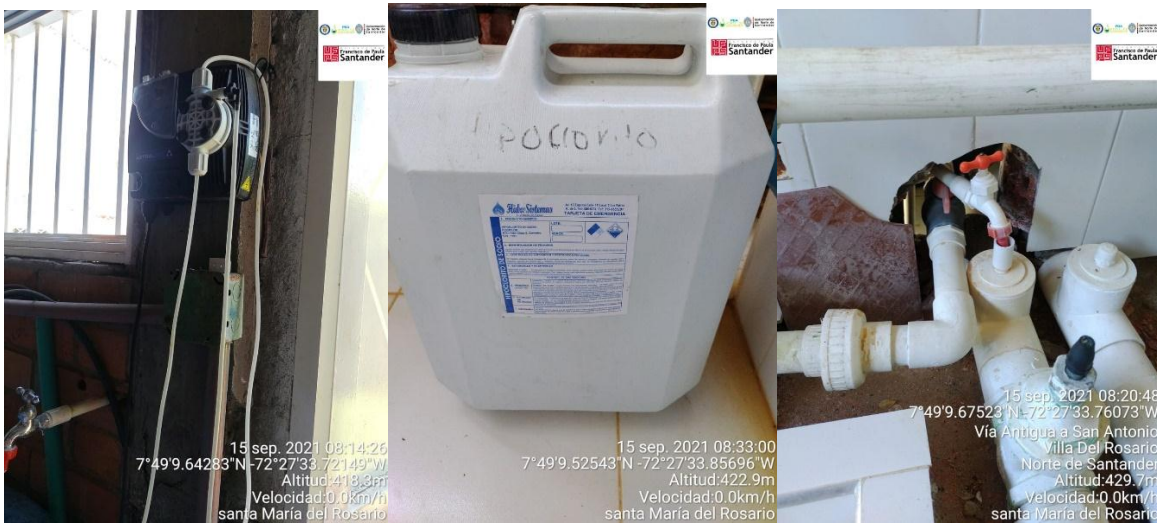
Figura 61. Dosificador de cloro, punto de cloración en la red PTAP Santa María del Rosario
