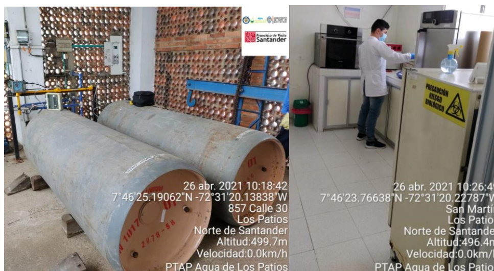
Figura 11. Estructuras de cloración y laboratorio. PTAP Agua de Los Patios
