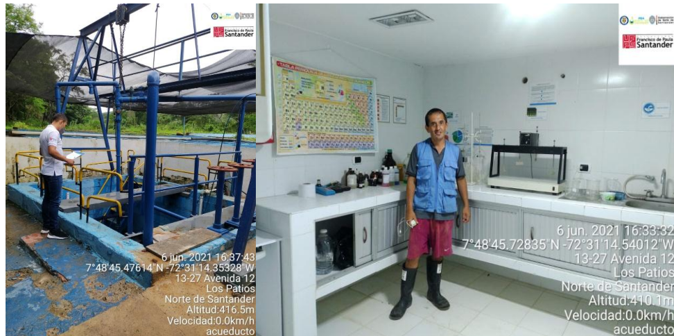
Figura 17. Estructura del filtrado y Laboratorio. PTAP Tierra Linda
