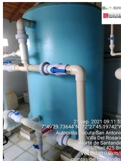
Figura 79. Batería filtrante de arenas y carbón activado. PTAP Quintas del Tamarindo I
