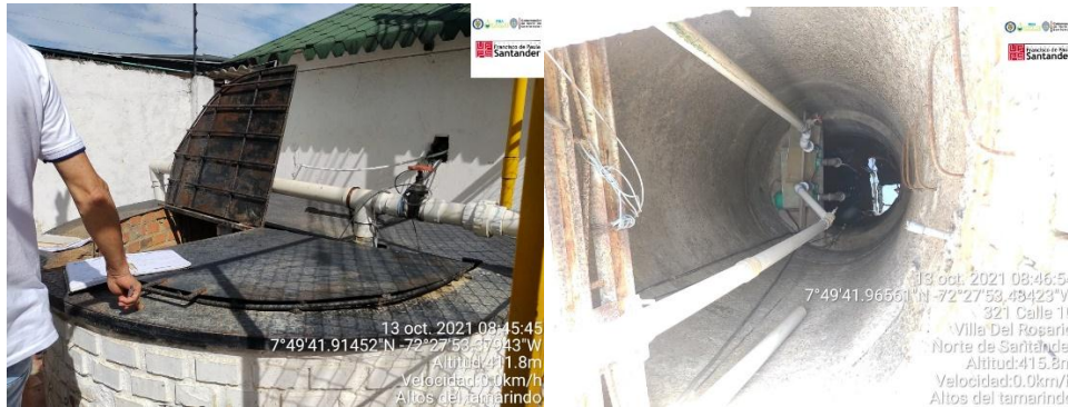
Figura 96. Pozo de agua subterránea. Fuente de abastecimiento. PTAP Altos del tamarindo
