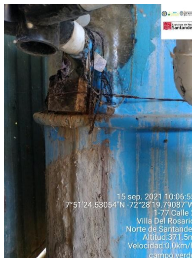
Figura 71. Fugas en batería filtrante #1. ASOCAMVE
