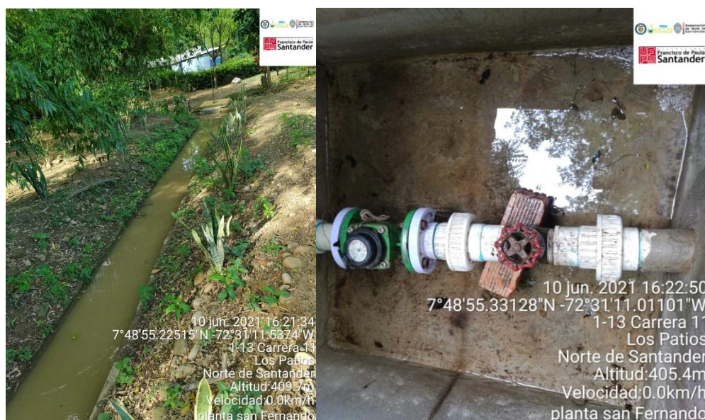
Figura 21. Estructura del Desarenador y Macromedidor de ingreso. PTAP San Fernando
