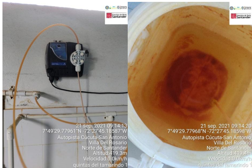
Figura 81. Mezcla de cloro y bomba dosificadora. PTAP Quintas del Tamarindo I
