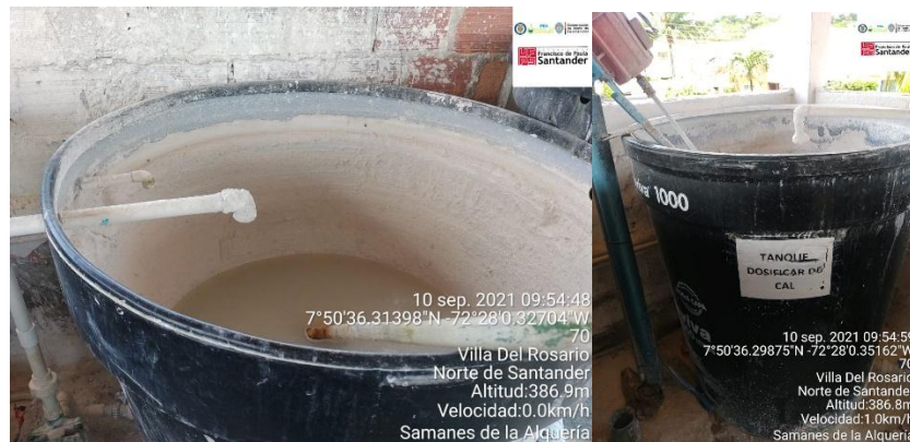
Figura 46. Tanque dosificador de cal . PTAP Samanes de los Trapiches
