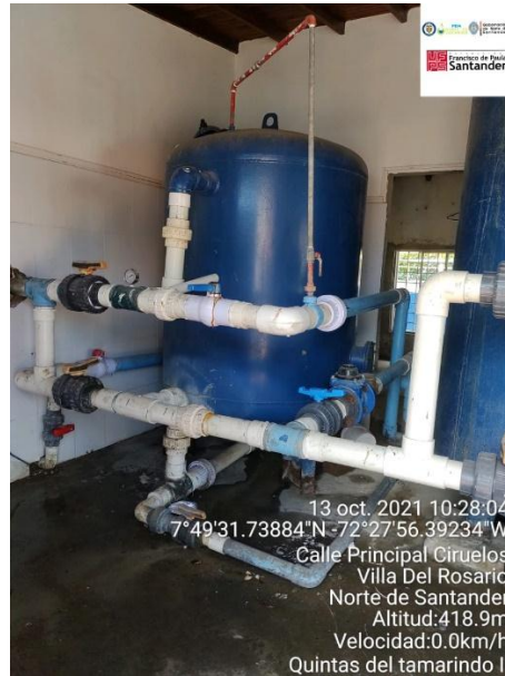
Figura 103. Batería filtrante de arenas y carbón activado PTAP planta Quintas del Tamarindo II
