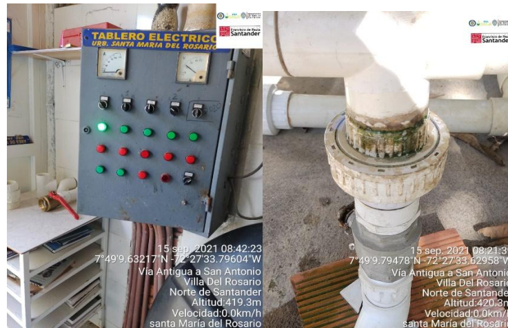
Figura 64. Recomendaciones de reparación de zonas con afectaciones (conexiones eléctricas, fugaz en zona de bombeo. PTAP Santa María del Rosario
