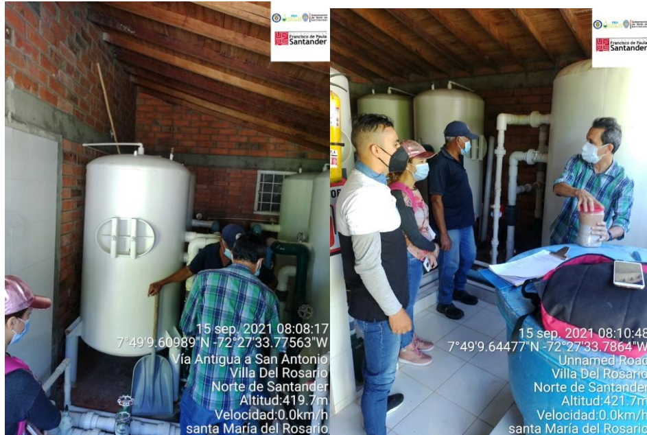
Figura 59. Baterías filtrantes PTAP Santa María del Rosario
