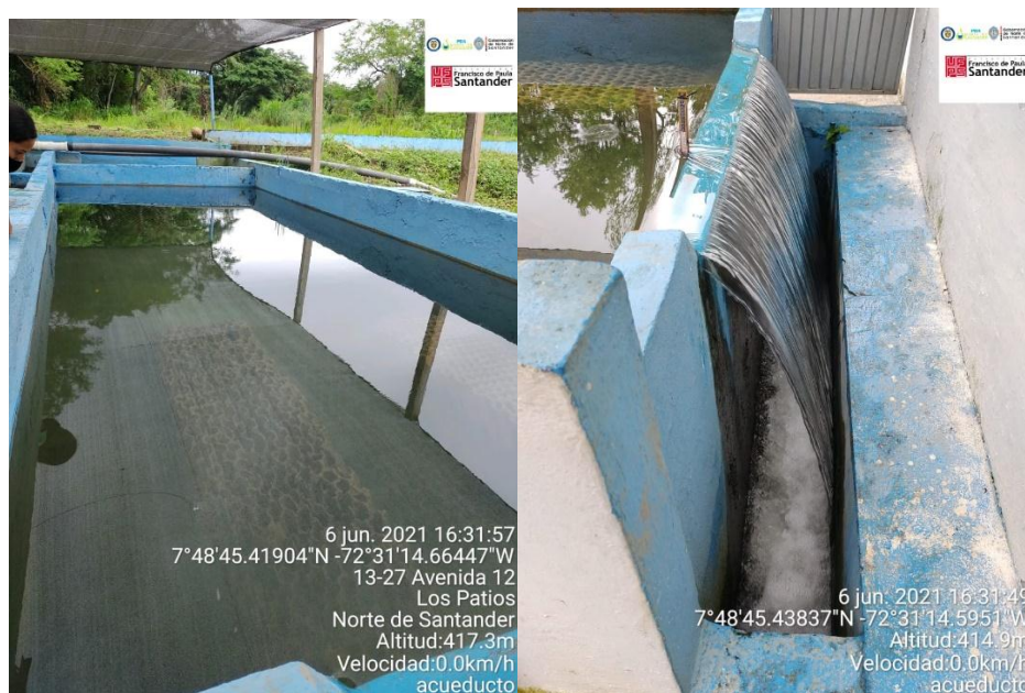
Figura 16. Estructura del Sedimentador. PTAP Tierra Linda
