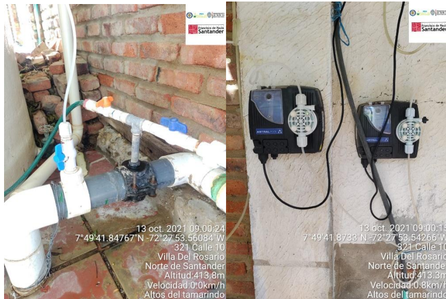
Figura 98. Punto de cloración y bombas dosificadoras. PTAP Altos del tamarindo
