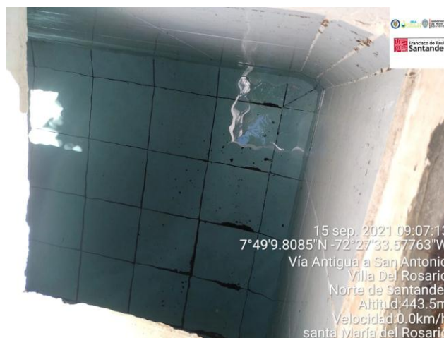
Figura 62. Tanque de almacenamiento PTAP Santa María del Rosario
