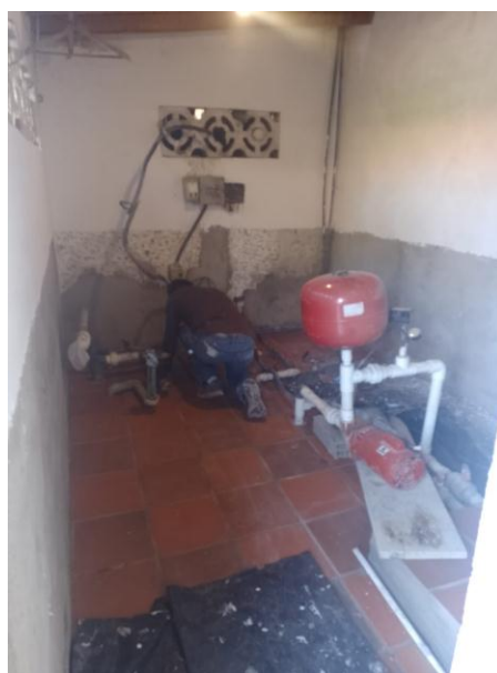
Figura 113. Zona de bombeo. El Nisperal.
