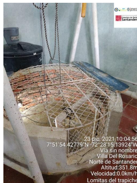
Figura 132. Pozo de agua subterránea PTAP Lomita de los Trapiches
