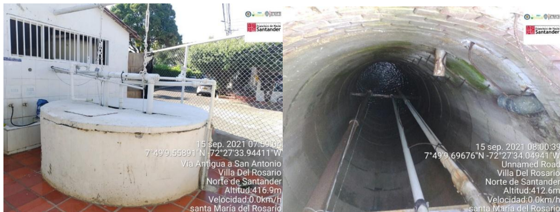
Figura 58. Fuente de abastecimiento, pozo subterráneo. PTAP Santa María del Rosario
