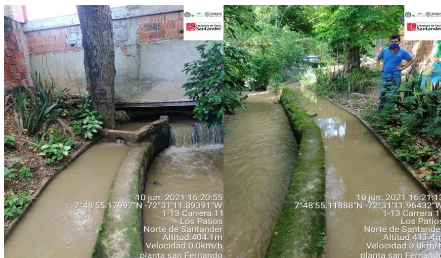
Figura 20. Bocatoma y Aducción. PTAP San Fernando
