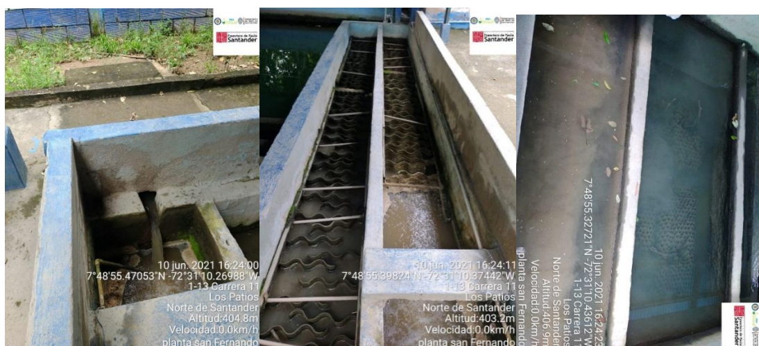
Figura 22. Estructura de Mezcla Rápida, Floculador y Sedimentador. PTAP San Fernando
