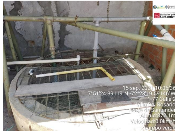
Figura 68. Pozo de agua subterránea, materiales que pueden generar posibles fuentes de contaminación. ASOCAMVE
