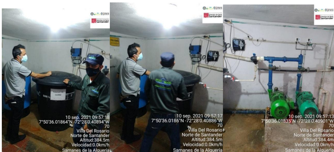
Figura 50. Tanque de mezcla de cloro, dosificador de cloro y mezcla con el agua filtrada.
