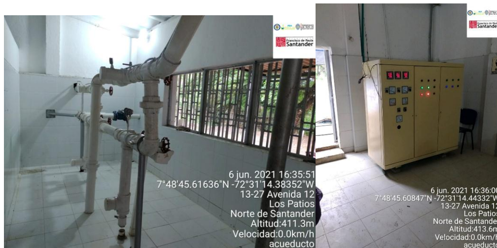
Figura 18. Sistema de Válvulas y planta de bombeo. PTAP Tierra Linda
