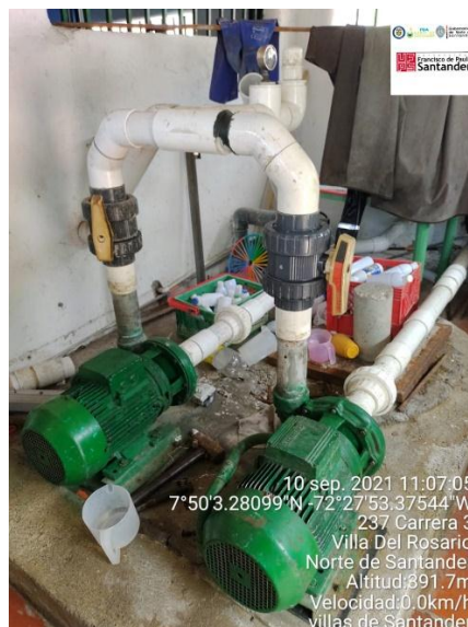
Figura 54. Zona de bombeo del agua cruda y agua clorada. Villas de Santander
