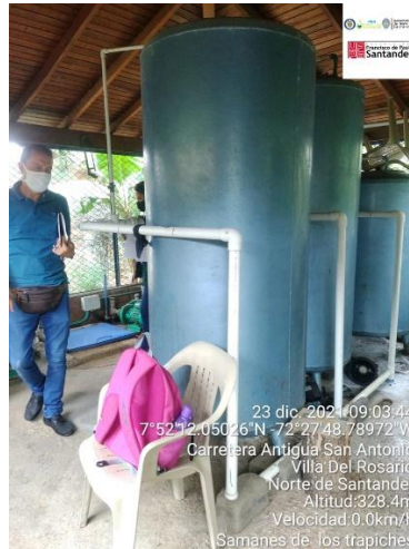
Figura 127. Batería filtrante de resina cationica PTAP Samanes de los Trapiches
