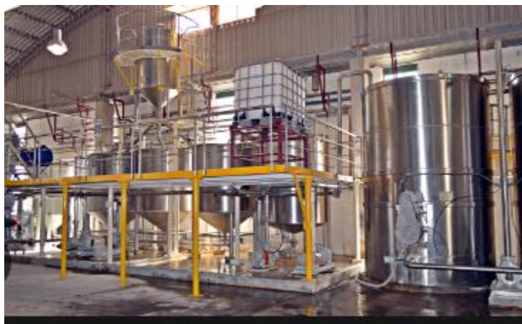
Figura 7. Sistema de filtración
