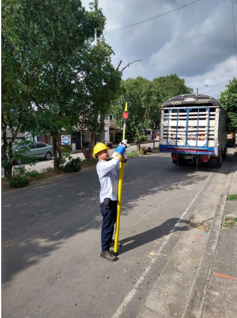
Figura 18 Verificación de funcionamiento de Pinza Voltiamperimetrica
