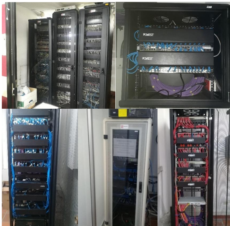
Figura 6. Fotografías de algunos centros de cableado
