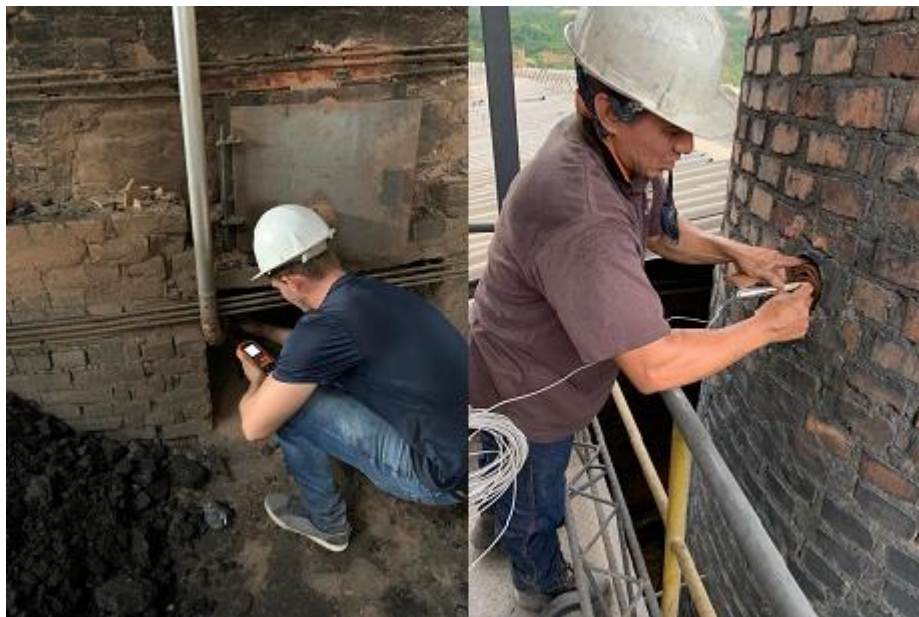
Figura 19. Instalación de termopar y datos de velocidad de aire.
