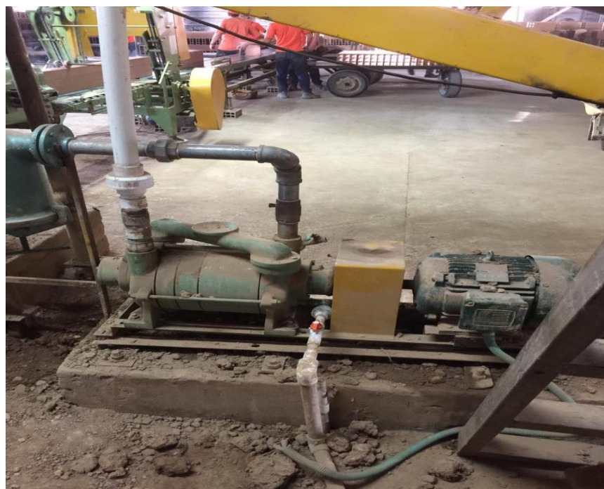
Figura 10. Bomba de vacío de la zona de extrusión.
