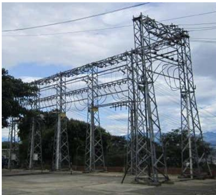
Figura 173. Celdas de distribución nivel 34,5 KV. Tomado de: Subestación eléctrica de San Mateo (Cácu, 2012)
