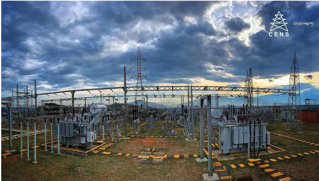
Figura 174. Subestación eléctrica Belén. Tomado de: CENS.
