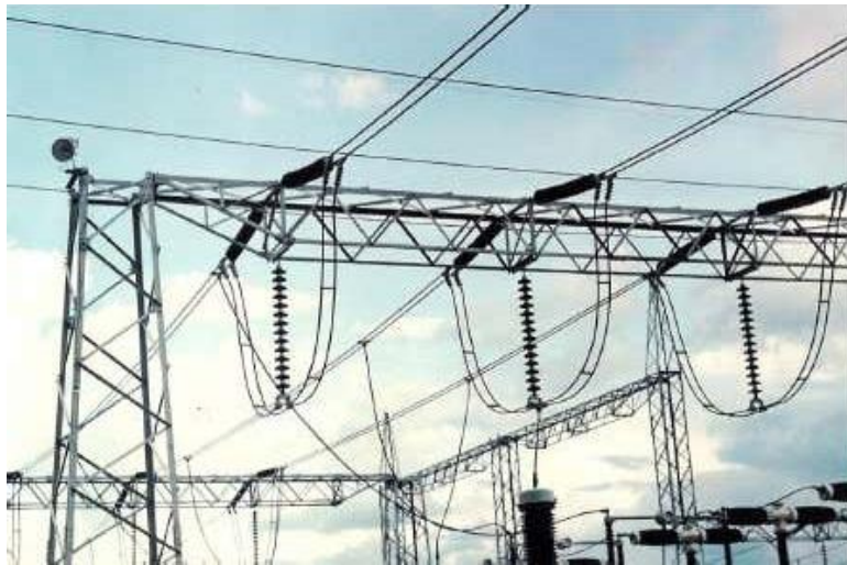
Figura 171. Configuración del barraje de la SESM-Cúcuta. Tomado de: Subestación eléctrica de San Mateo (Cácu, 2012)
