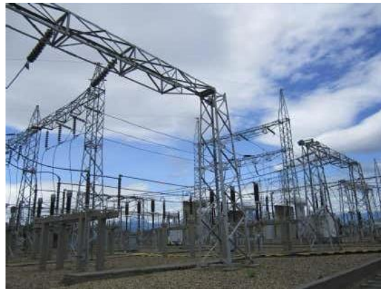
Figura 169. Subestación eléctrica de San Mateo, Cúcuta. Tomado de: Subestación eléctrica de San Mateo (Cácula, 2012)
