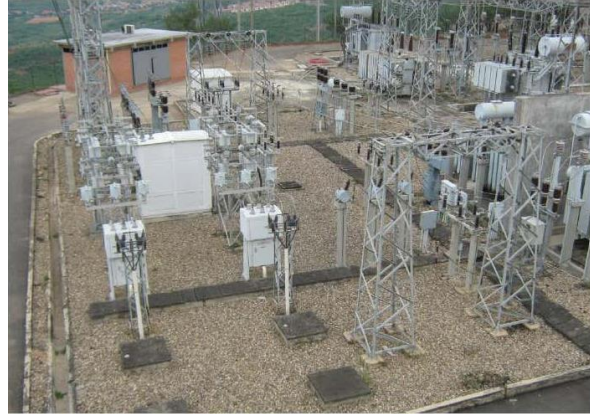
Figura 168. Subestación eléctrica de San Mateo, Cúcuta. Tomado de: Subestación eléctrica de San Mateo (Cácula, 2012)
