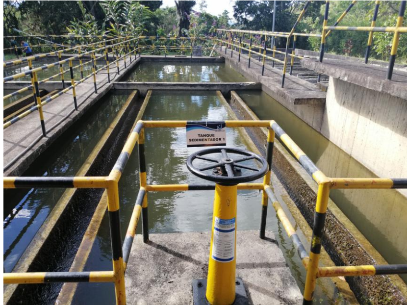
Figura 20. Válvulas del Tanque Sedimentador PTAP Chinácota EMCHINAC, con Presencia de Oxidación en las barandas, Variación de Color, Moho, Vegetación
