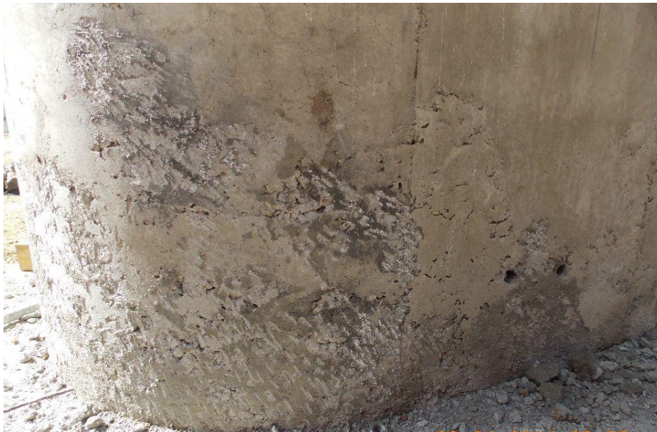
Figura 87. Estructura con Presencia de Hormiguero
