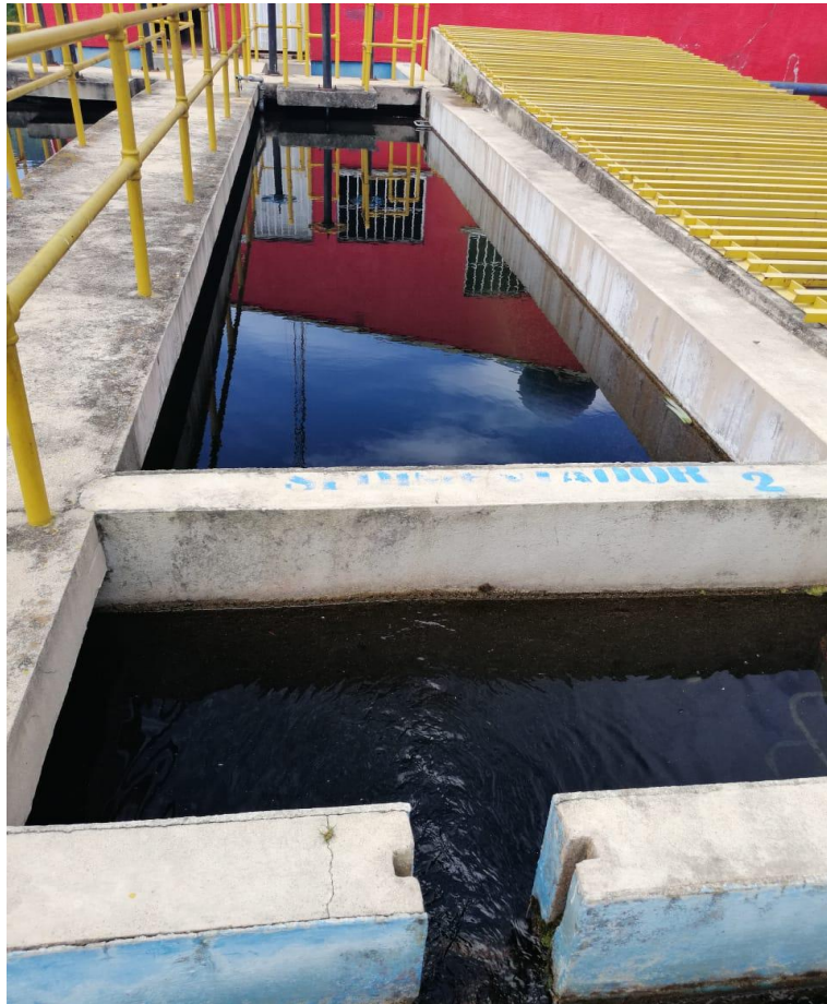
Figura 17. Sedimentador 2 con Presencia de Fisuras, Vegetación, Variación de Color. PTAP Durania.
