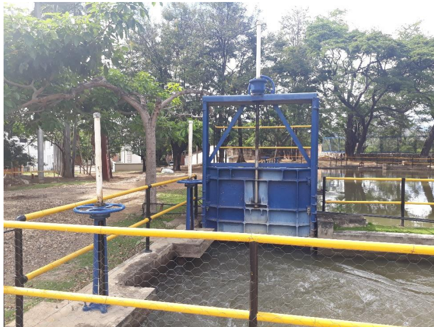
Figura 9. Compuerta con Presencia de Variación de Color. PTAP El Pórtico (Cúcuta)
