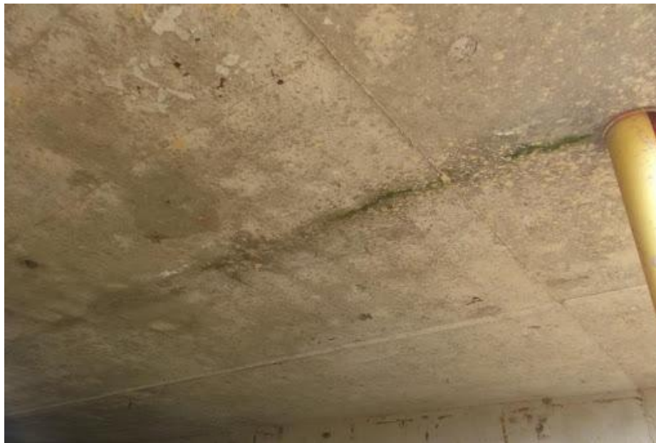
Figura 91. Estructura con Presencia de Moho
