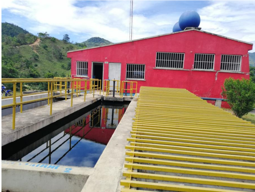
Figura 65. Planta de Tratamiento de Agua Potable Durania
