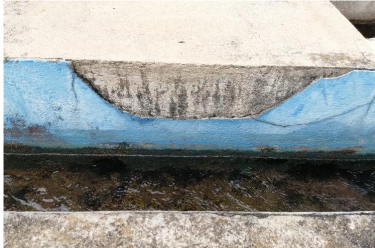
Figura 24. Descascaramiento del Concreto en Desarenador, Presencia de Fisuras, Moho, Variación de Color PTAP Durania
