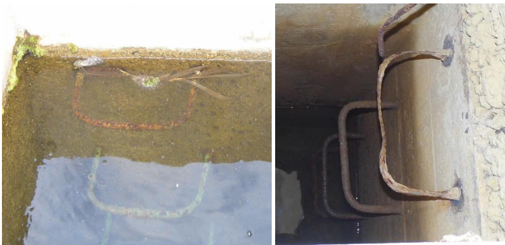
Figura 34. Corrosión Metálica en Escaleras de Tanques PTAP Chinácota- PTAP Durania, con Presencia de Vegetación, Moho, Hormiguero, Variación de Color
