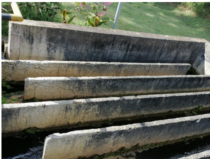
Figura 14. Floculador con Presencia de Moho, Vegetación, Variación de Color, Lavado de la Pasta Superficial de Cemento. PTAP Chinácota (EMCHINAC)
