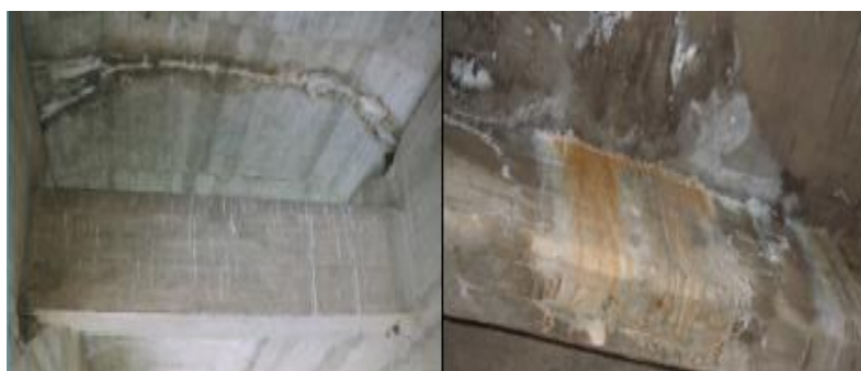
Figura 36. Eflorescencias en Elementos Estructurales
