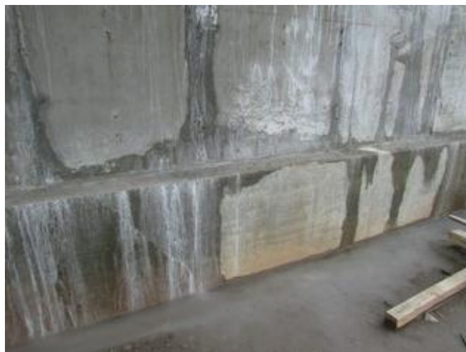
Figura 25. Fuga de Lechada, Presencia de Variación de Color, Eflorescencia
