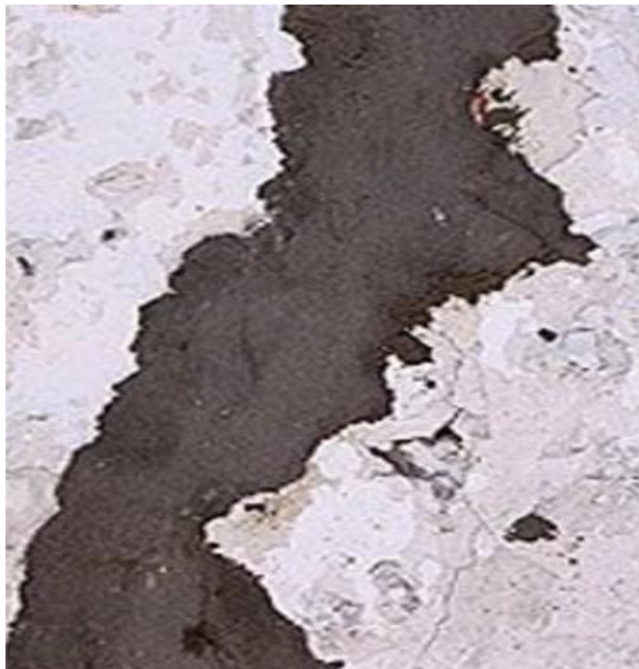
Figura 104. Desprendimiento de Pañetes
