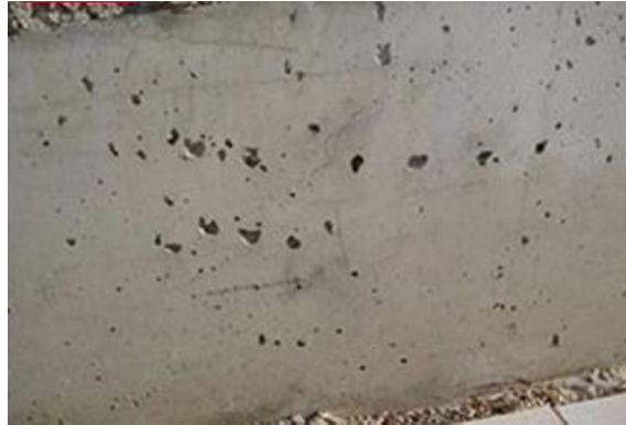
Figura 27. Hormiguero Presente en Elemento Estructural
