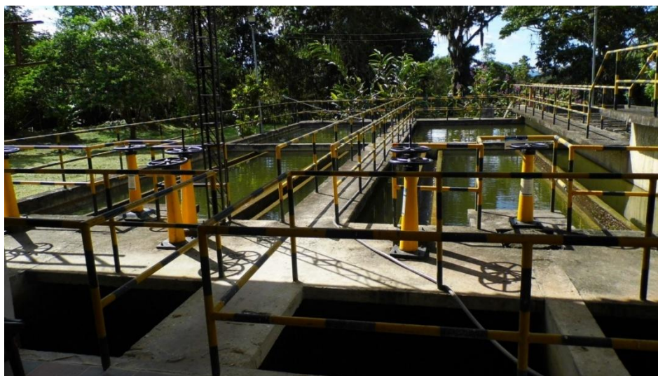
Figura 61. Planta de Tratamiento de Agua Potable Chinácota EMCHINAC E.S.P
