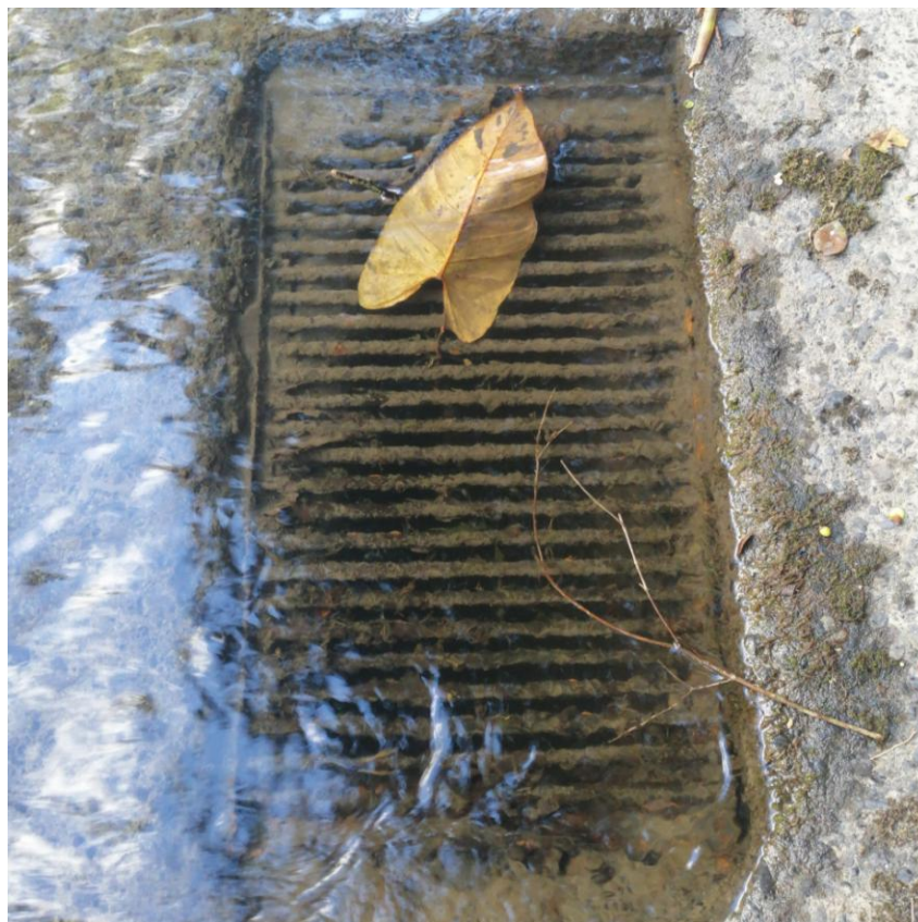
Figura 18. Rejilla con Presencia de Moho, Vegetación Bocatoma PTAP Chinácota, EMCHINAC
