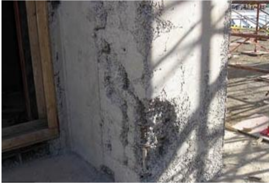
Figura 22. Burbujas Presentes en un Elemento Estructural, Columna
