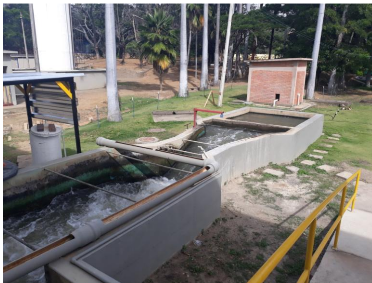
Figura 11. Canaleta Parshall con Presencia de Variación de Color, Moho, Vegetación, Eflorescencia. PTAP El Pórtico
