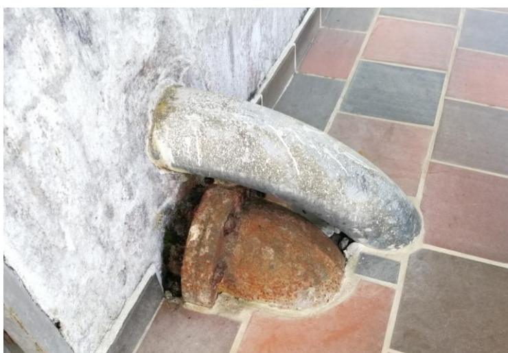
Figura 12. Anclaje Tubería de Hierro con Presencia de Corrosión Metálica. PTAP Chinácota, EMCHINAC
