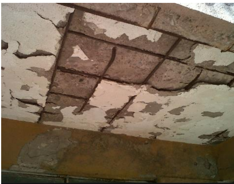
Figura 35. Disgregación en Placa
