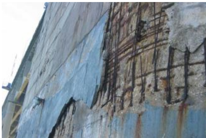
Figura 32. Presencia de Sulfatos en Estructuras
