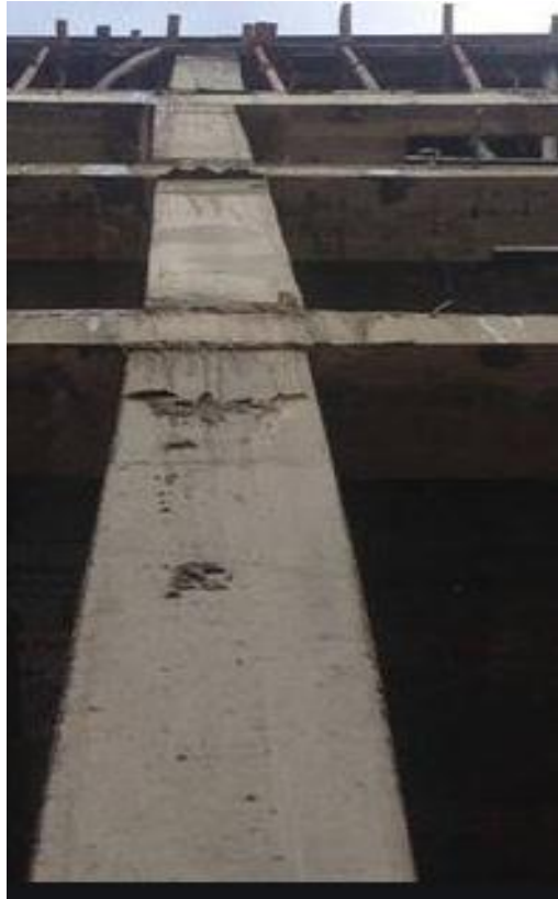
Figura 23. Desalineamiento Presente en un Elemento Estructural, Columna
