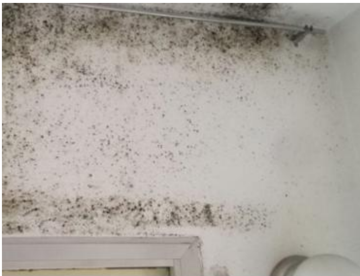
Figura 96. Humedad por Condensación en la Estructura
