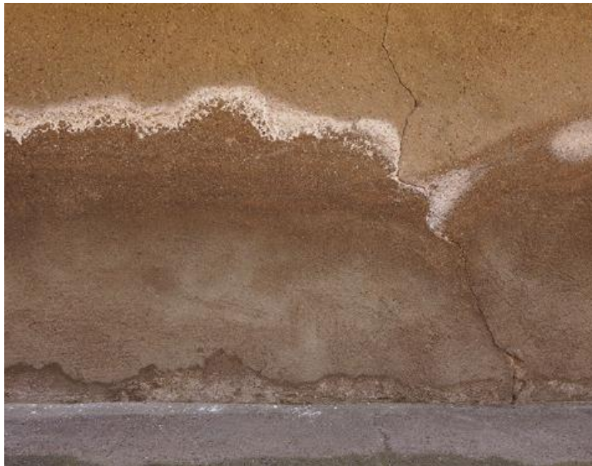
Figura 97. Eflorescencias en la Estructura
