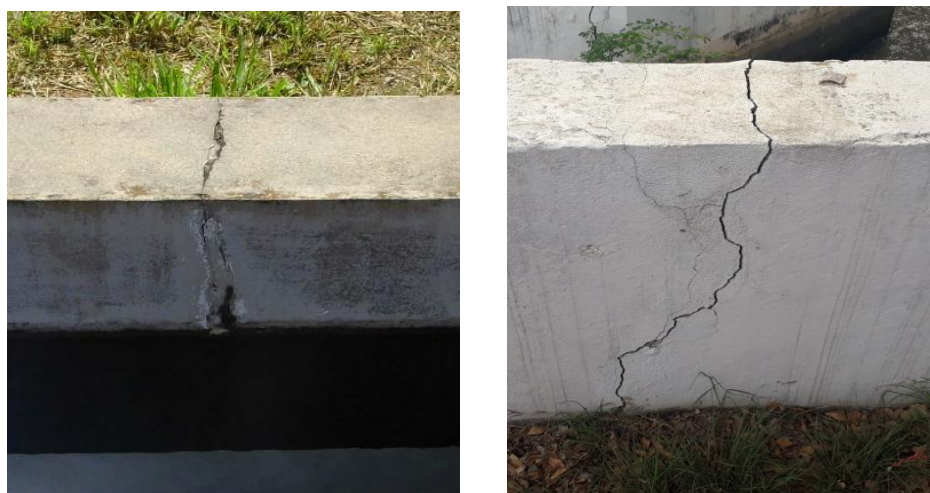
Figura 26. Grietas PTAP Durania Sedimentador -El Pórtico Cúcuta Canaleta de Entrada, Presencia de Vegetación, Variación de Color, Moho.
