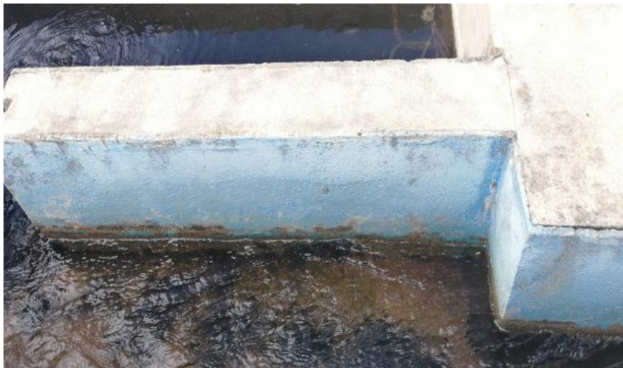
Figura 33. Corrosión por Lixiviación en Estructuras, Presencia de Moho, Variación de Color, Eflorescencia, Fisuras, Oxidación, Vegetación
