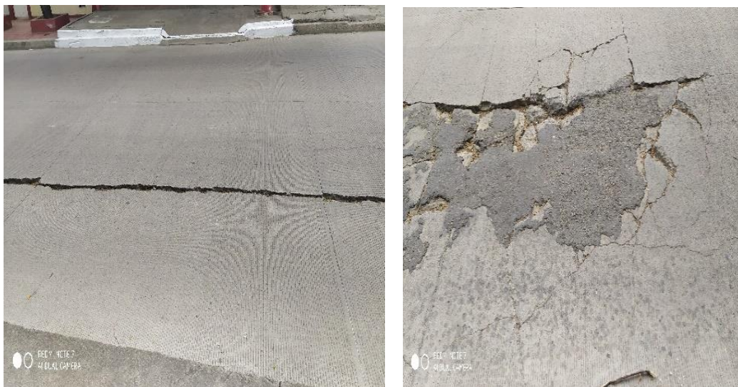
Figura 20 Grietas longitudinal y parcheo asfáltica, Tramo 8, (Abscisa K0 +682) Fuente: Autor
