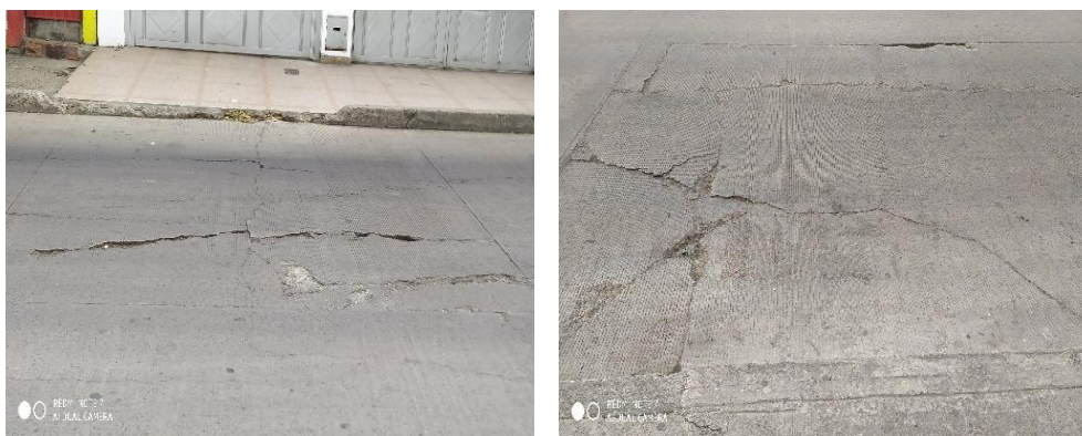
Figura 18 Grietas en bloques, Tramo 6 (Abscisa K0 + 373) Fuente: Autor
