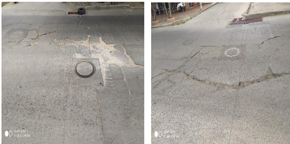
Figura 19 Grietas por sumideros, Tramo 8 (Abcisis K0 + 646) Fuente: Autor
