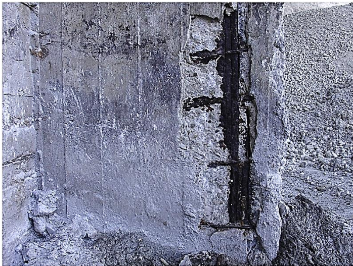
Figura 39. Daño en columna del depósito de yeso. (Piasta, 2017)
