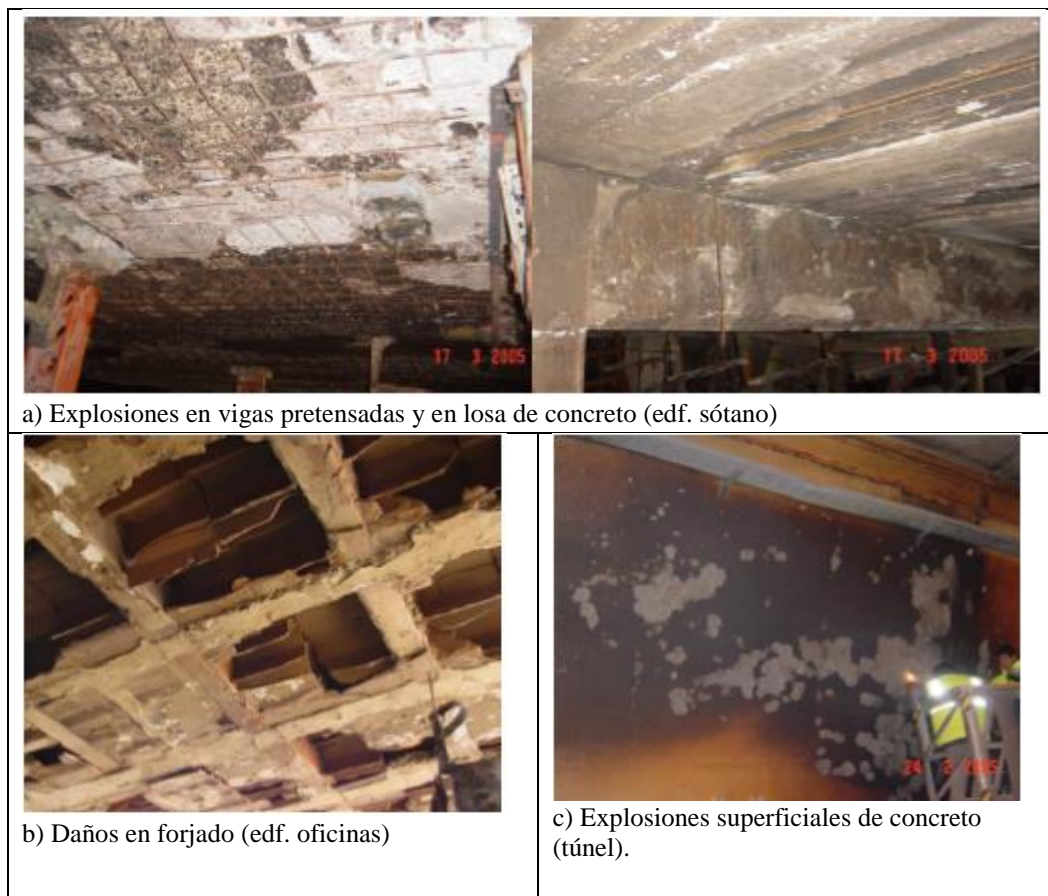
Figura 174. Daños en elementos de hormigón después del incendio. (Alonso et al., 2013)
