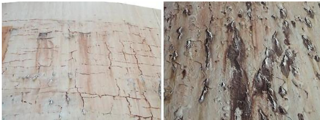
Figura 102. Detalles de la fisuración en la pared del reservorio. (Sollero & Bolorino, 2016)
