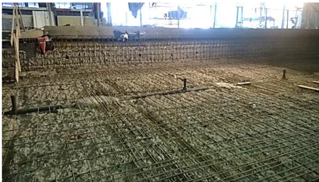
Figura 151. Refuerzo superior de losa de tierra. Se instalaron nuevas tuberías de tratamiento de agua antes del refuerzo.(Lahdensivu & Aromaa, 2015)
