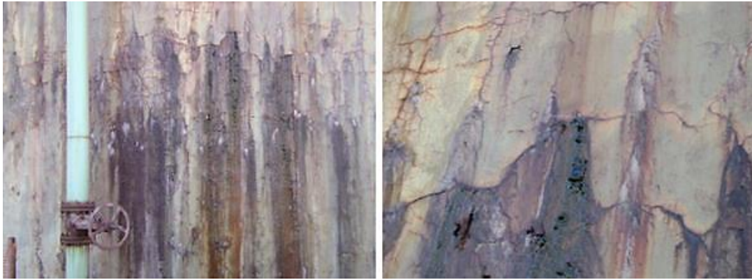
Figura 104. Detalles de la pared del reservorio presentando fisuración y filtración de agua. (Sollero & Bolorino, 2016)
