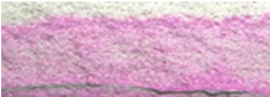
Figura 50. Imagen típica de color en sección del concreto rociado con una solución de fenolftaleína. Choi, J., Lee, Y., Yong, Y., & Yeon, B. (2017).
