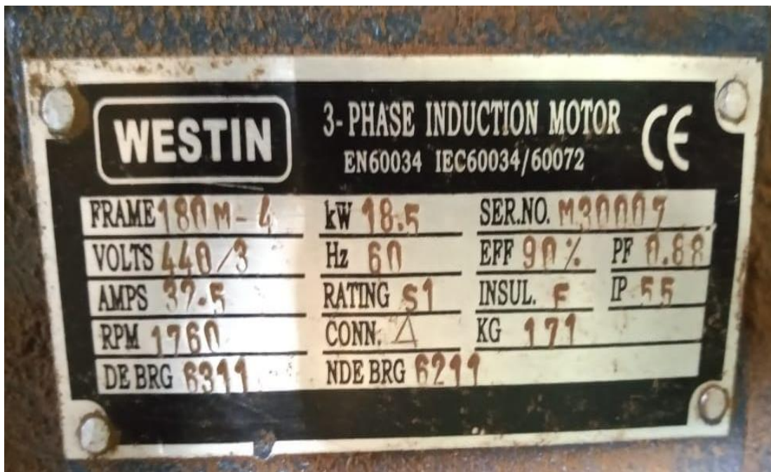
Figura 15 Placa del motor (ventilador centrifugo)
