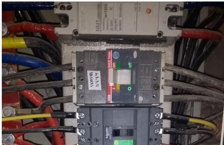
Figura 26. Totalizador de luces 1°, 2°, 3° y 4° piso bloque SD
