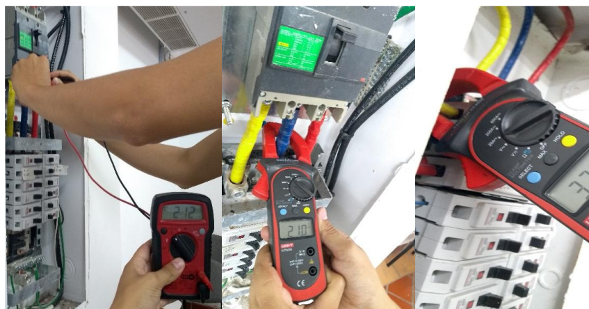
Figura 22. Medidas de voltajes y corrientes en los tableros eléctricos del edificio aulas sur nuevo
