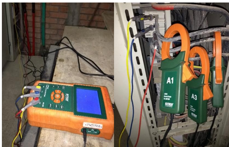
Figura 27. Conexión del analizador de redes en el totalizador del bloque SD
