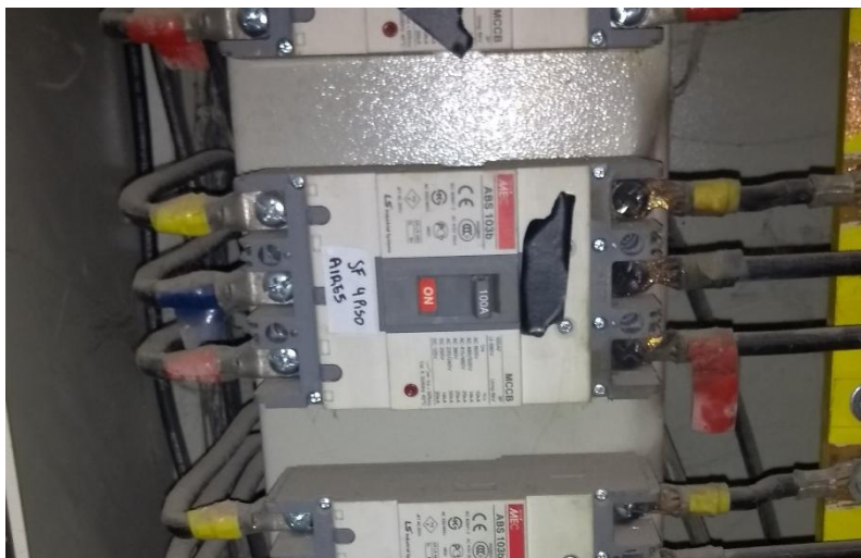
Figura 28. Totalizador de aires acondicionados 4º piso bloque SF.
