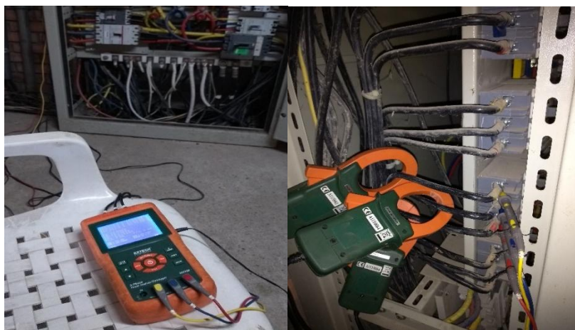
Figura 29. Conexión del analizador de redes en el totalizador del cuarto piso del bloque SF.
