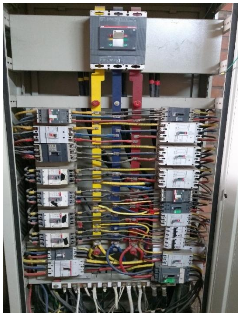
Figura 24. Tablero general de la subestación
