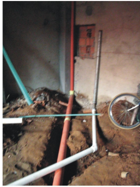
Se muestra el bajante de la columna A7 y la conexión en tubería H.G de el gabinete contra incendios de el primer piso.
