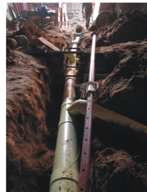
Muestra parte de el recorrido de la tubería de aguas negras que se conecta finalmente a la caja de la entrada de el almacén, la tubería es de 6 pulg.
