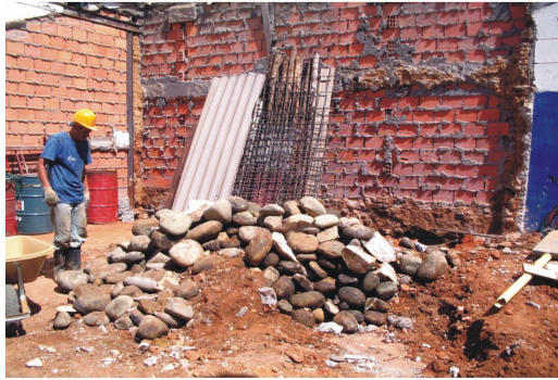
Llegada de la piedra de río o mojones para la elaboración del concreto ciclópeo.
