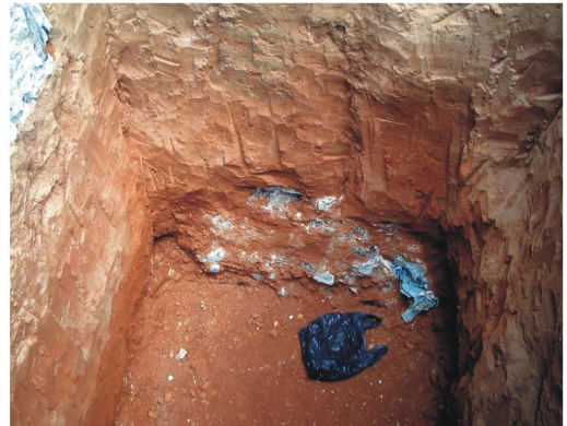
En la excavación de esta zapata se aprecian los cimientos de la anterior edificación, que muchas veces pueden afectar el rendimiento de la actividad de a cuerdo a su composición y estado.
