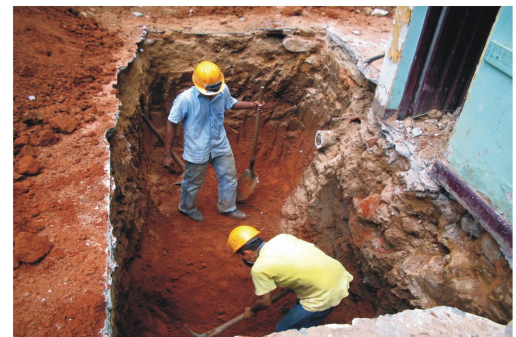
Excavación de las zapatas D4 y D3, en esta imagen se aprecia que la demolición de la antigua cimentación ha retrasado un poco esta actividad, además se en la zapata D3 se encontró un desagüe de la edificación vecina.
