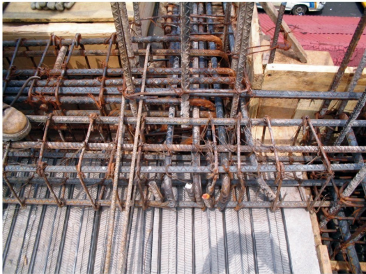
Las vigas perimetrales deben testerearse para la fundida, con buena y resistente madera, se utiliza tabla y media y se adecua según la necesidad.
