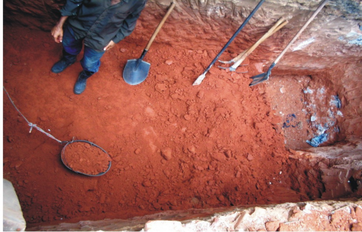
Preparación para la excavación de zapatas, herramienta a utilizar, pala, pica, barra y baldes, contando con la protección del personal que consta de botas, tapa boca guantes y casco.
