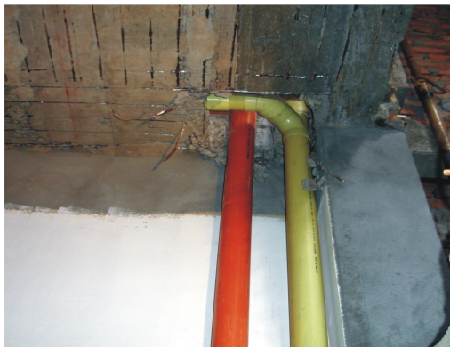
En esta ocasion la tubería de aguas negras se ramifica a través de una y para recibir las aguas negras de los baños del segundo piso y poder continuar a recibir las del tercer.
