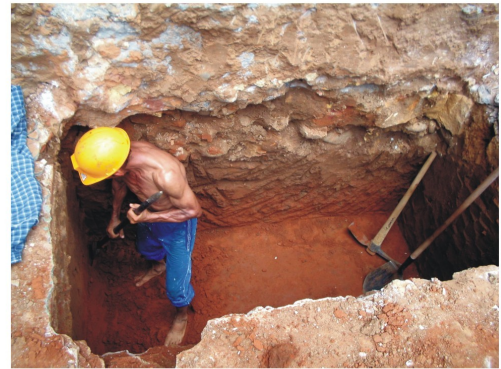
Este tipo de situaciones son propensas a accidentes, es necesario que el personal entienda la necesidad del el equipo de seguridad, este obrero esta propenso a la picadura de un animal, ademas no posee guantes, ni camisa, ni tapa bocas.
