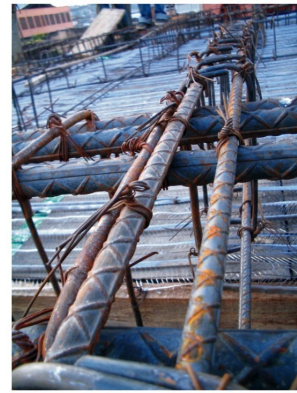
Las uniones de los hierros se realizan con el bichiroque, elemento que se realiza en obra, y alambre negro o #18.
