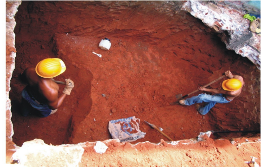
Excavación de la zapata F7 de 3.20*1.70 con una profundidad de 2.60mt, demolición de vigas de concreto de la anterior construcción.
