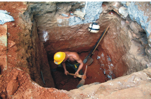
Excavación de la zapata A7 de dimensiones 1*1 y profundidad 2.6mt, es de vital importancia que el personal mantenga las normas de bio seguridad para evitarse sanciones.
