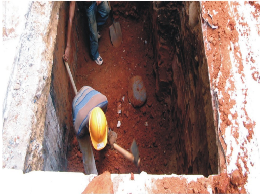
Una vez alcanzada la profundidad requerida en la excavación de la zapata se procede a nivelar o emparejar los costados o paredes de la zapata, para luego proceder a fundir el concreto ciclópe.
