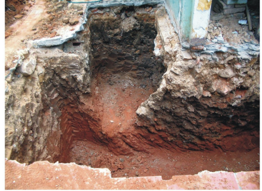
Proceso de excavación de la zapata D4, muestra del terreno aun sin emparejar sus costados.
