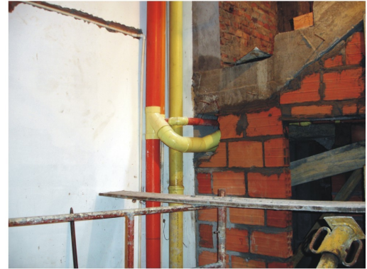
Esta imagen enseña el empalme de reventilacion que tiene salida a la ultima placa, el tubo de succión de el tanque subterráneo al aéreo , aguas lluvias y negras.
