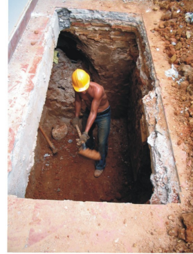
En la excavación de la zapata F7 se encontraron unas perforaciones que llevaban hacia la zapata G7 con unas filtraciones mínimas, estas perforaciones fueron previamente rellenadas y tratadas para continuar con el trabajo.
