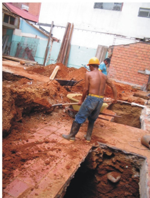
Al fondo de la foto, el maestro Ernesto Otero, verificando el proceso de excavación, en primer plano un ayudante en movimiento de tierra para eliminar el relleno innecesario.
